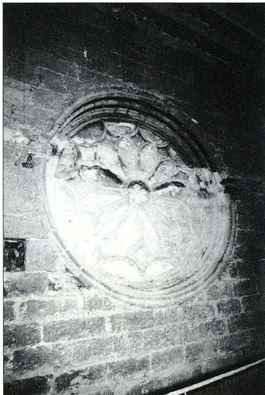
El rosetón medieval, cegado, en el muro norte y hoy oculto sobre la cúpula de la capilla de san Víctor.
