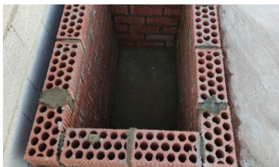
Imagen 78: Realización de arquetas en la zona de cubetos para vertido ocasional de líquidos.
