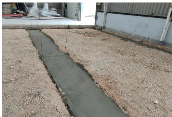
Imagen 95: Cimentación en zona de decantación de líquidos para posterior colocación de canaletas de evacuación de aguas.
