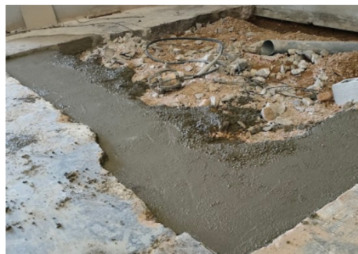
Imagen 49: Llenado de la cimentación de los aseos ubicados en la parte posterior de la nave.
