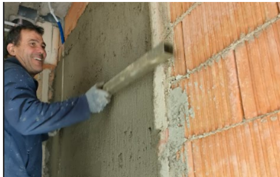
Imagen 76: Maestreado de mortero en paredes de aseos de la nave para posteriormente alicatado con gres porcelánico.
