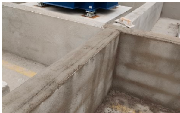
Imagen 94: Enlucido y remates superiores en paredes de la zona de cubetos exteriores.
