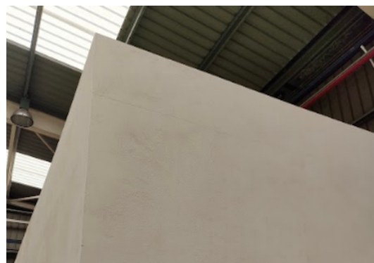
Imagen 111: Reparación de grieta en zona de aseos. Esta grieta se debe a un fallo de ejecución, ya que el operario se le olvidó poner malla en una parte de la pared donde se requería.
