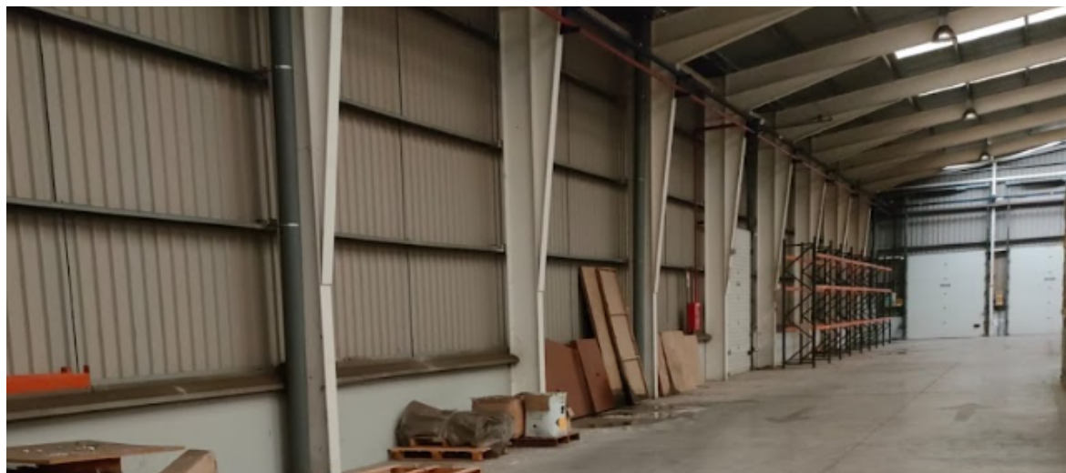
Imagen 15: Bajante de pluviales
