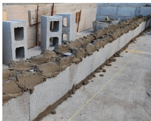
Imagen 51: Se puede apreciar al detalle en la imagen la colocación del bloque de hormigón con el mortero.
