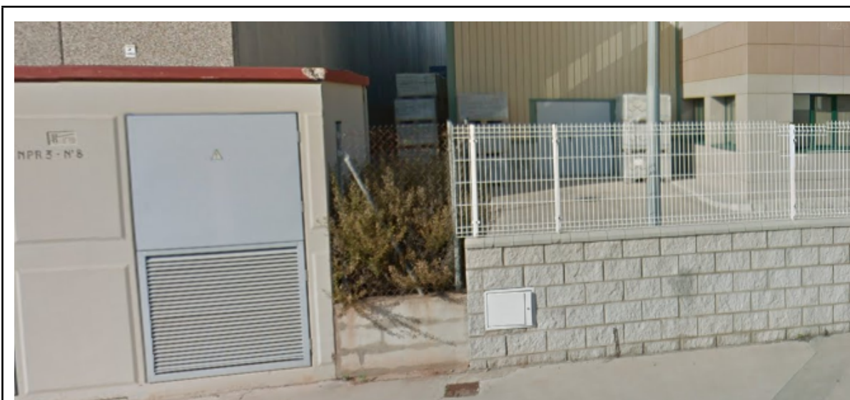
Imagen 13: Caseta prefabricada de luz en fachada.
