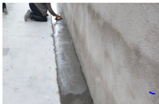
Imagen 79: Remate entre la pared de bloque realizada y solera, dejando pendientes para que el agua pueda evacuar correctamente
