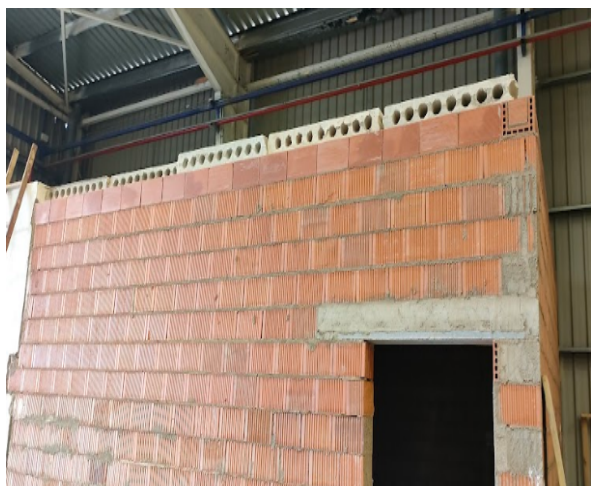
Imagen 58: Colocación de techo de placas alveolares en aseos de la parte trasera de la nave. Posteriormente se procederá al encofrado y vertido de la capa de compresión
