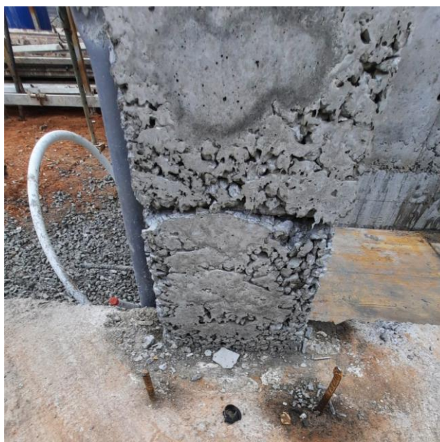
Fig 53. Defectos por la falta de vibración del hormigón.
