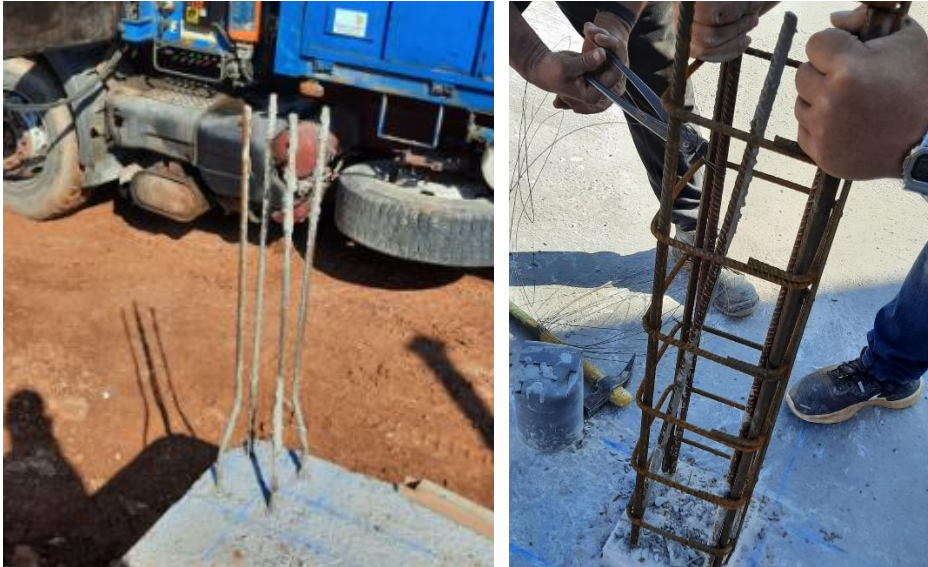
Fig 126. Colocación el armado de los pilares (eliminación de los cercos de armd. Esperas)
