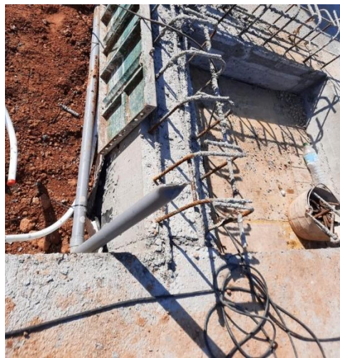
Fig 129. Instalaciones de saneamiento.
