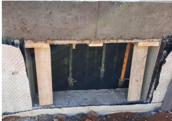
Fig 123. Huevo de ventilación en P. Sótano.
