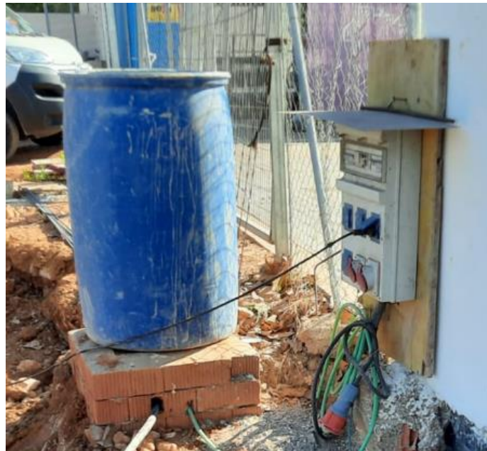
Fig 88. Instalación eléctrica provisional.
