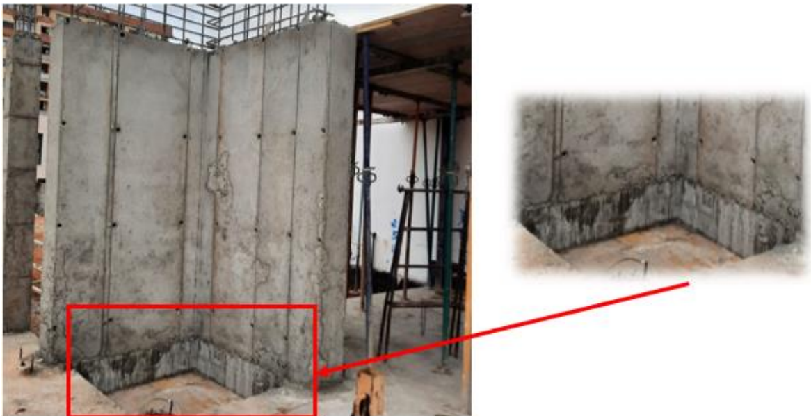
Fig 52. Eflorescencias y manchas en el hormigón.
