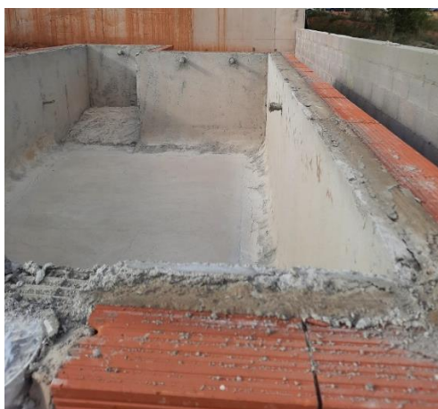
Fig 98. Instalaciones de la piscina.
