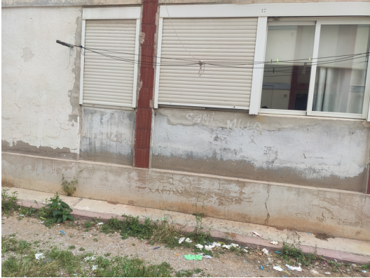
Figura 19. Ventanas de aluminio sin Rotura de Puente Térmico. Fachada Trasera.
