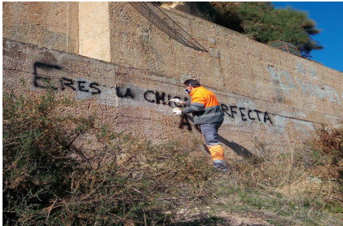
Figura 3. Actos de vandalismo en los muros del castillo
