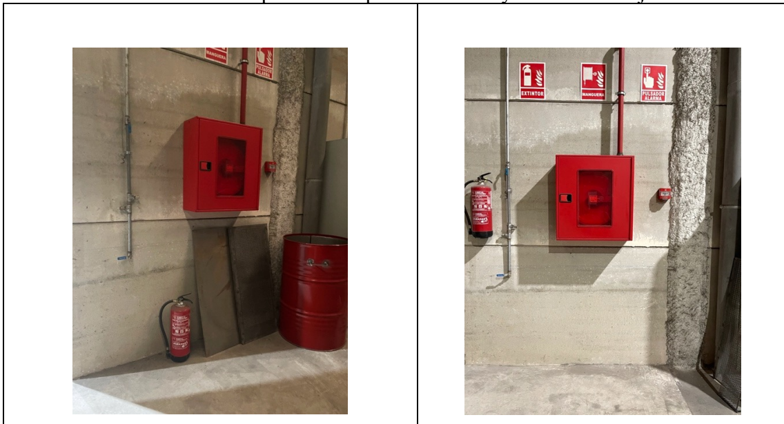
Ilustración 16. Materiales impidiendo el paso a extintor y mesa de trabajo.
