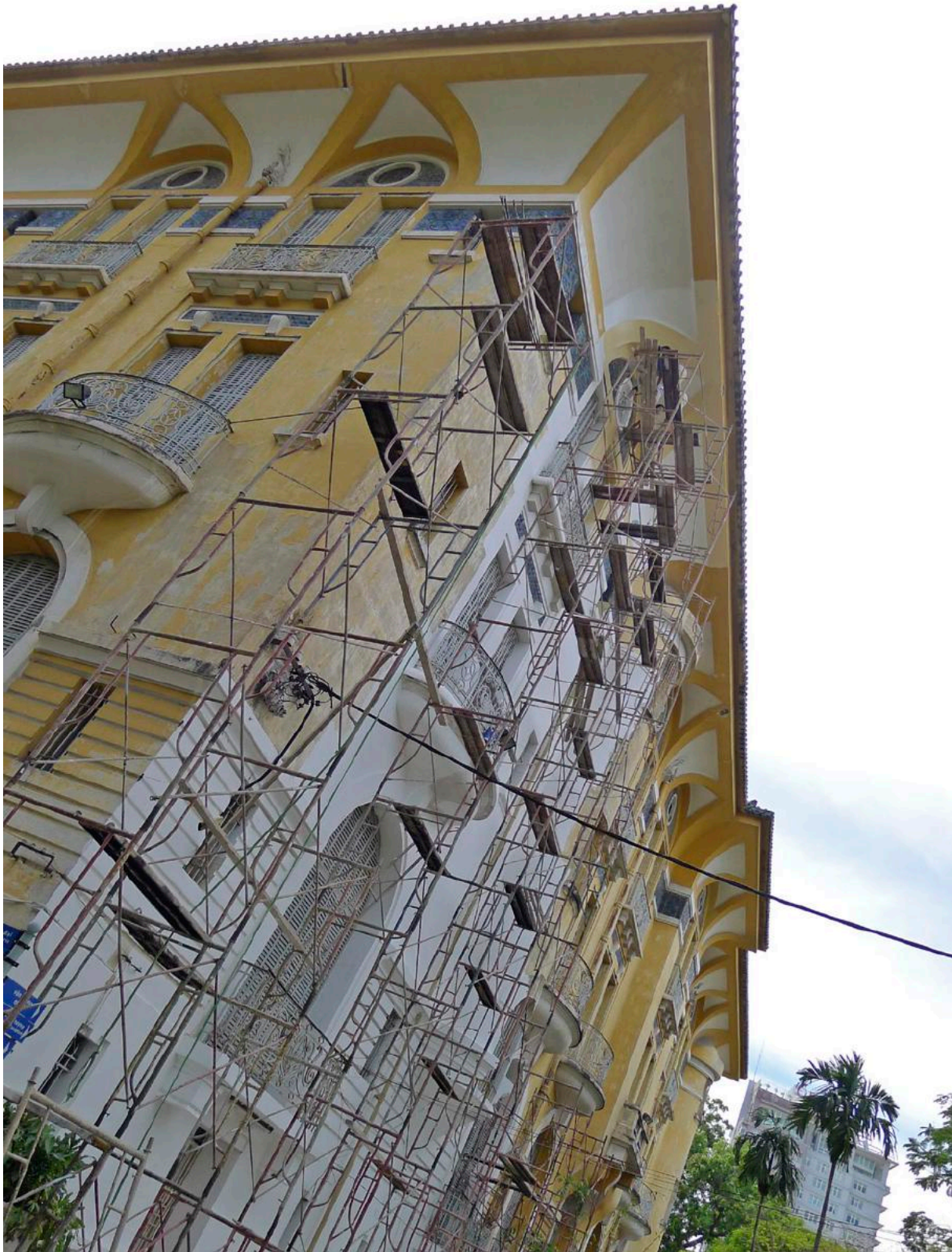
Restauración de la fachada del Museo de Bellas Artes de Ciudad Ho Chi Minh en 2011. La nueva pintura aplicada ha cubierto la superficie de cal ocre original. Fotografía de la autora.
