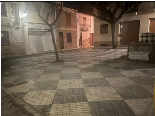
Plaza del Rosario, estado del pavimento.
