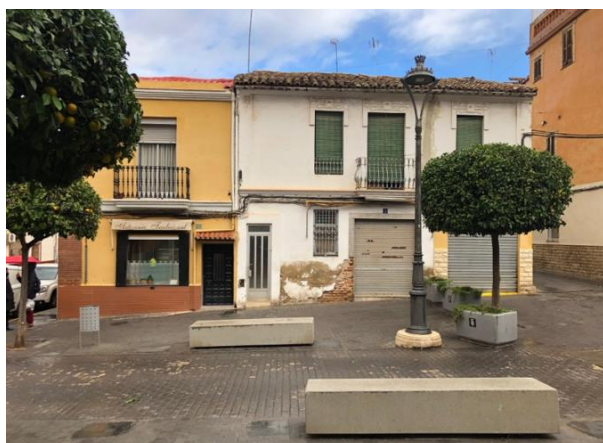
Mobiliario actual Plaza de la Morería, se aprecia el deterioro del pavimento.
