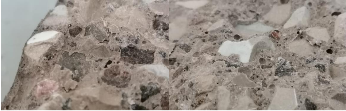
Figura 78. GP50. Detalle de la porosidad existente en la probeta del hormigón GP50. Detalle de la superficie esmaltada de la grava porcelánica reciclada en el hormigón GP50.
