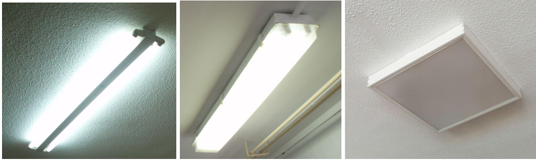
Imagen 5. Detalle de la iluminación interior del edificio .
