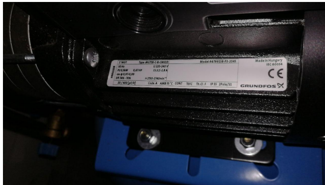
Imagen 16. Bomba del lavavajillas .
