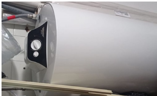
Imagen 17. Termo electrico 100L cocina.
