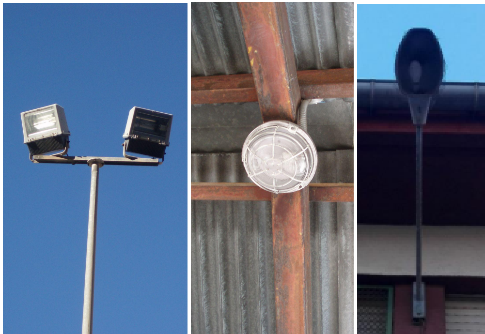
Imagen 6. Detalle de la iluminación exterior .
