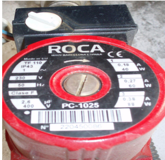
Imagen 24. Bombas Sala de calderas .
