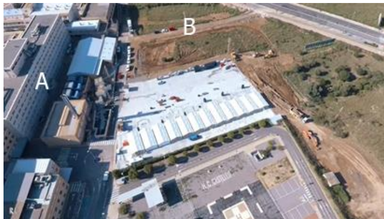
Figura 3: Proceso de montaje. (A: Urgencias; B: nueva carretera de acceso en construcción)
