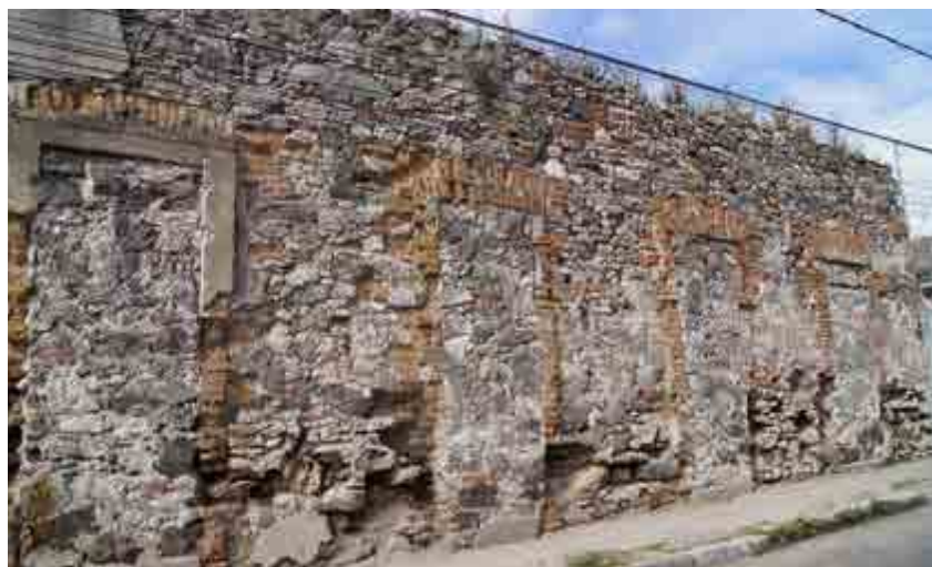
Ilustración 4. Fachada de la antigua casa de «La Locería» o «La Bolsa del Diablo», 24 Poniente 519 o 7 Norte 2208, en el Barrio del Refugio, año 2013. (Fotografía de Adriana Hernández Sánchez.)
