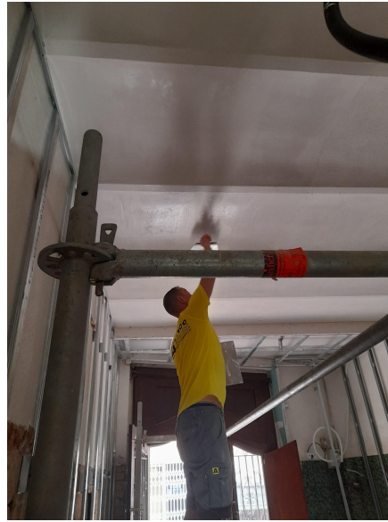
Imagen 200: Trabajos con productos nocivos.
