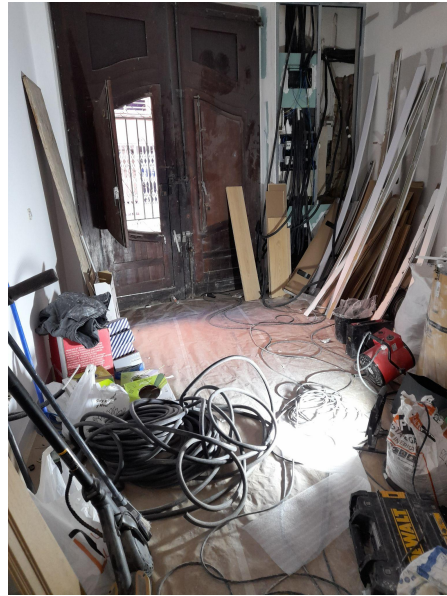
Imagen 205: Falta de orden y exceso de acopios.
