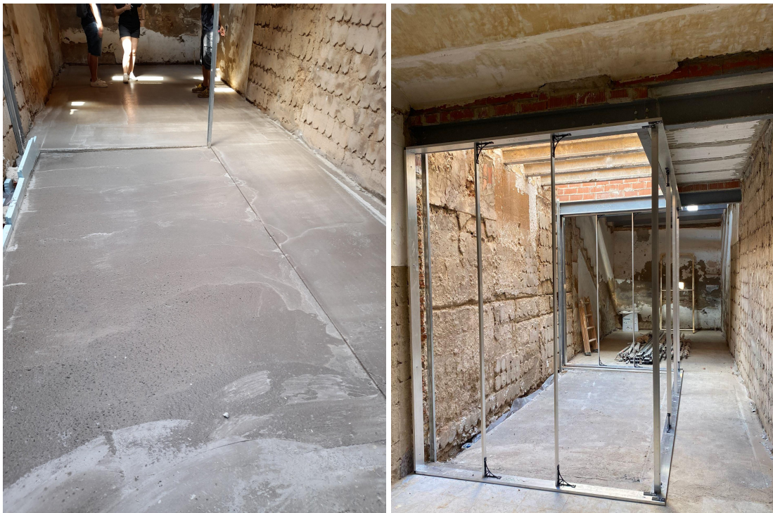
Imágenes 69-70: Vertido de autonivelante en solera, y colocación de premarco de carpintería.
