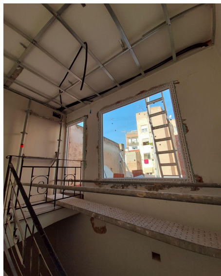
Imagen 103: Falso techo recayente en hueco de escaleras.
