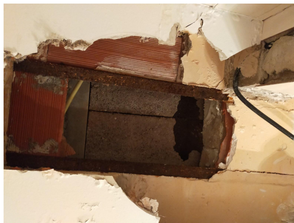
Imagen 30: Vigas metálicas corroídas soportando parte del forjado.
