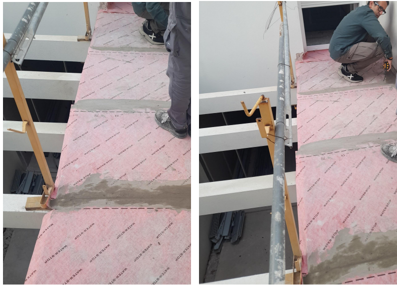
Imágenes 202-203: Falta de elementos en barandilla.
