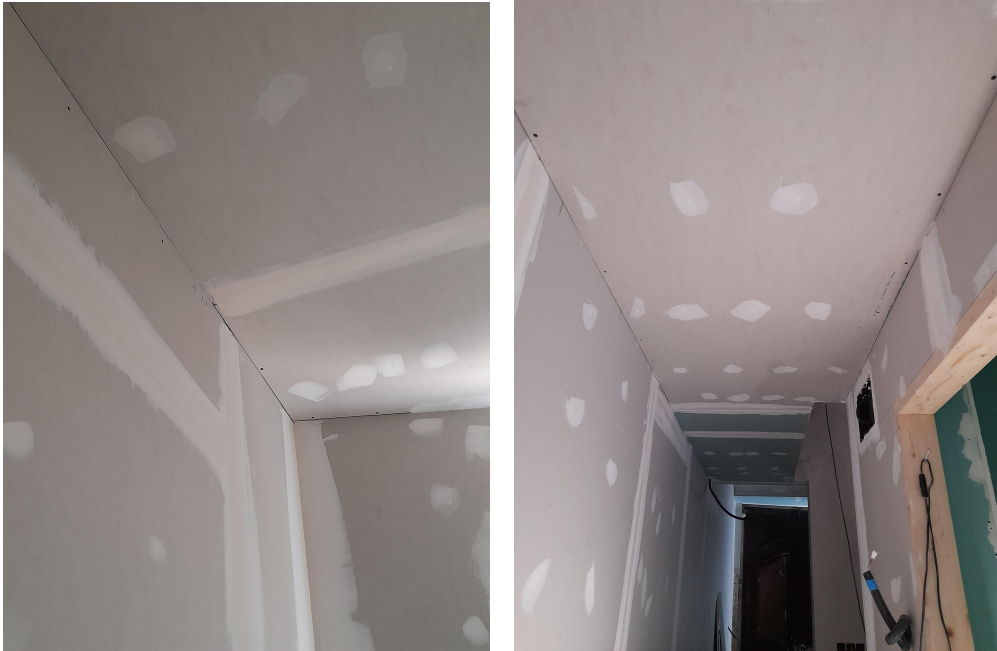
Imágenes 140-141: Encintado y masillado de juntas y tornillería de placas de cartón yeso.
