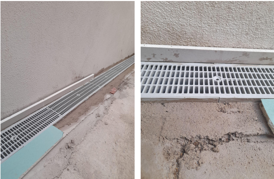
Imágenes 129-130: Colocación de rejilla gris de PVC en patio de planta baja con pendiente a un agua.
