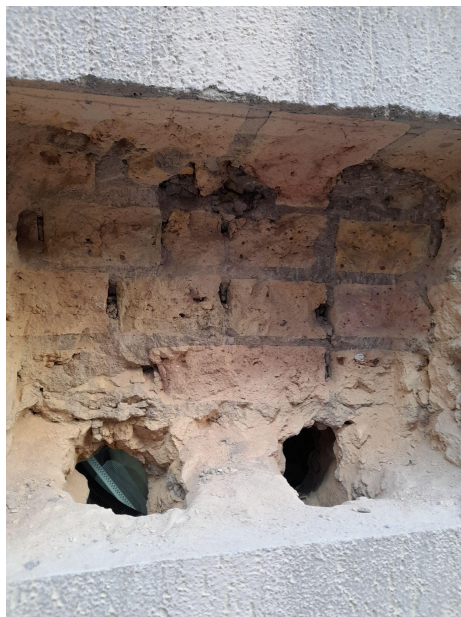
Imagen 160: Picado y apertura de perforaciones en zona de fachada con acabado de enfoscado bruñido.
