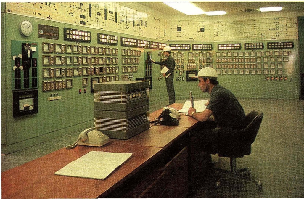
Centro de control electrónico del proceso de refino
