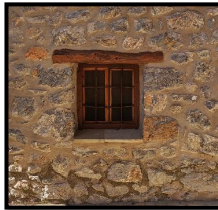
Figura 3.36. Llinda de Fusta en Finestra de Xodos. (Font: Autor.)
