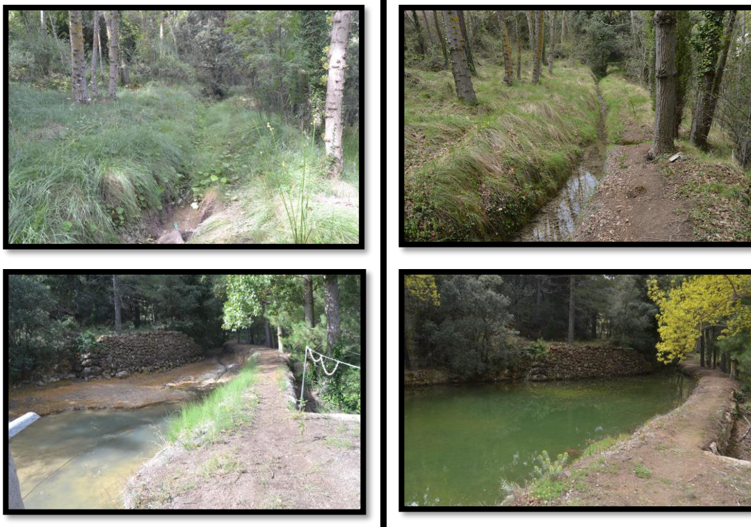
Figura 4.49. Treballs de neteja de la sequia per a que l'aigua arribe a la bassa amb més facilitat. (Font: Autor.)
