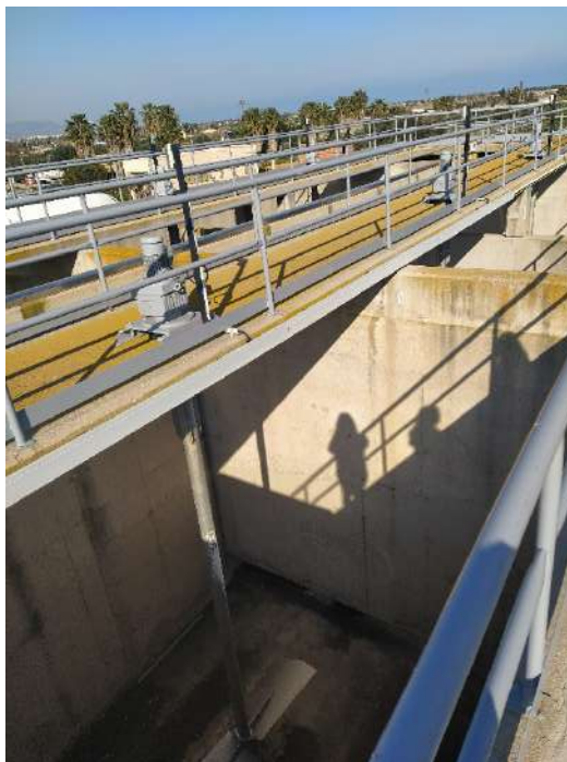
Figura M.5. Ejemplo de tanque de coagulación y floculación. Fuente: Fotografía capturada en la EDAR de Castellón.
