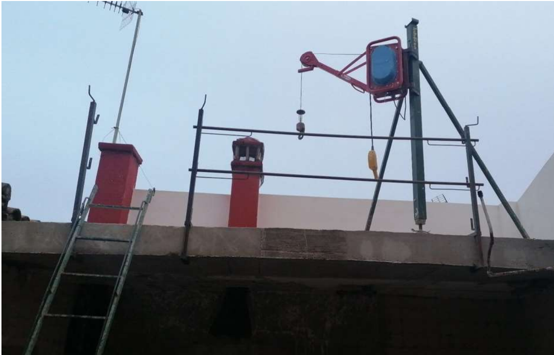
Imagen 96: Falta de tramos de barandilla, falta de rodapié de protección y la escalera no sobrepasa la altura de acceso lo suficiente (elaboración propia)
