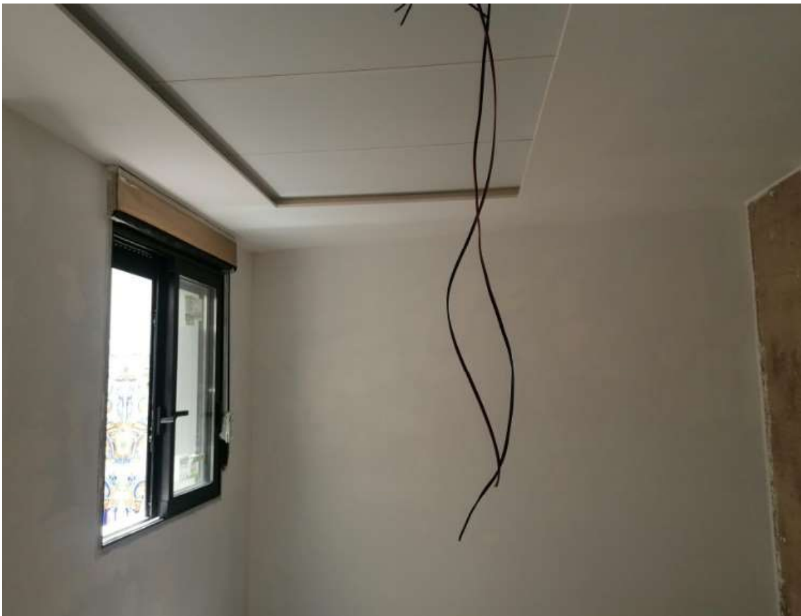
Imágenes 150 y 151: Estado de la cocina al momento de la entrega del trabajo final de grado (elaboración propia)
