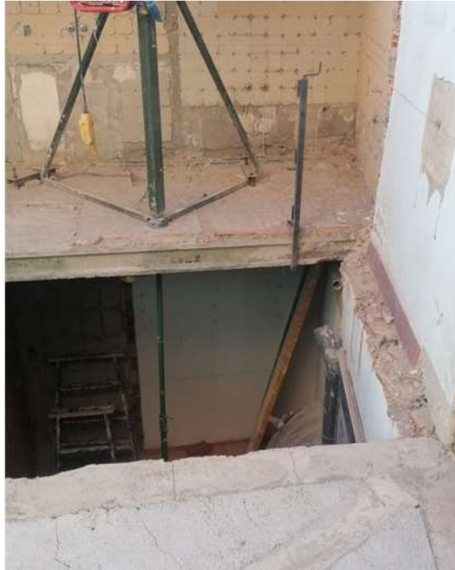
Imagen 94: Falta de protecciones colectivas en posible caída de altura (elaboración propia)
