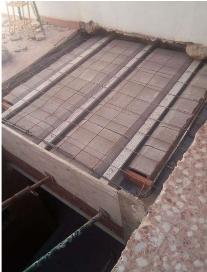
Imagen 93: Falta de protecciones colectivas en la realización de forjado unidireccional (elaboración propia)
