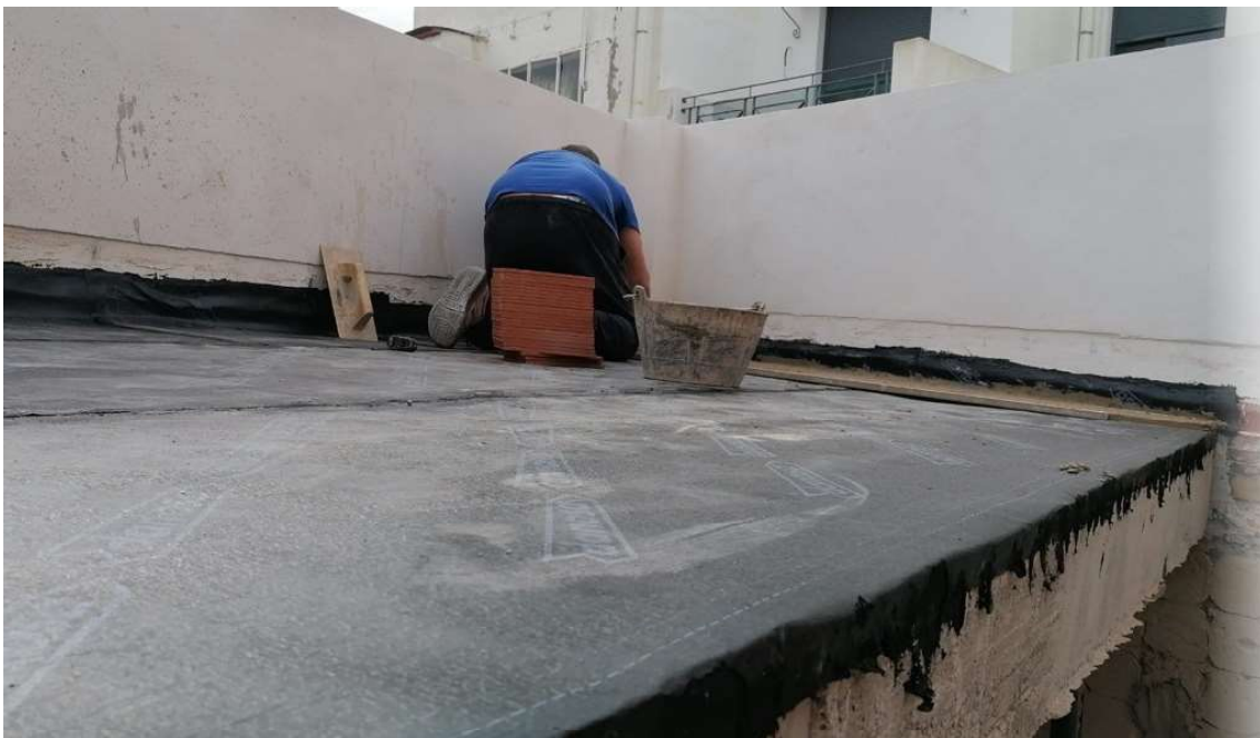
Imagen 99: Trabajo de operario sin protección alguna anticaída (elaboración propia)
