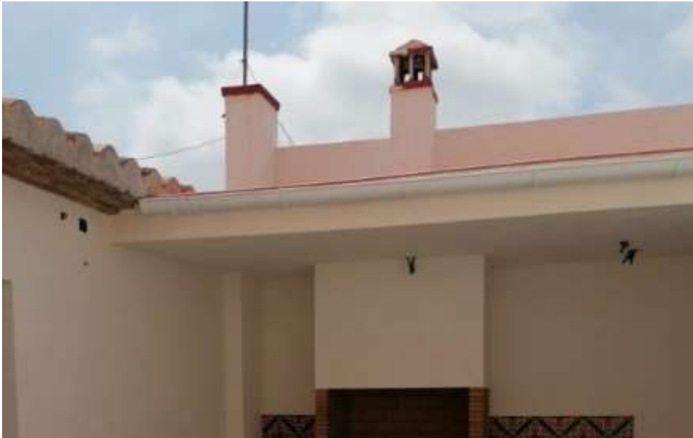
Imagen 22: Se muestra que los antepechos no están terminados con albardilla (elaboración propia)
