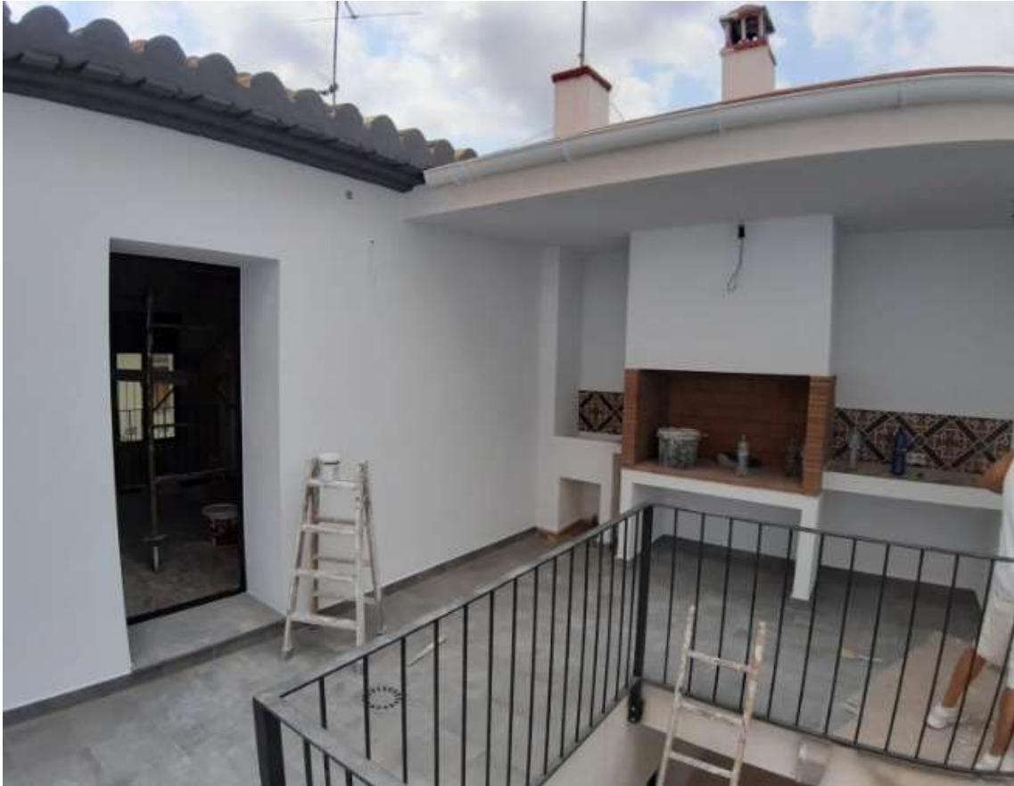
Imágenes 163, 164 y 165: Estado de la terraza posterior al momento de la entrega del trabajo final de grado (elaboración propia)
