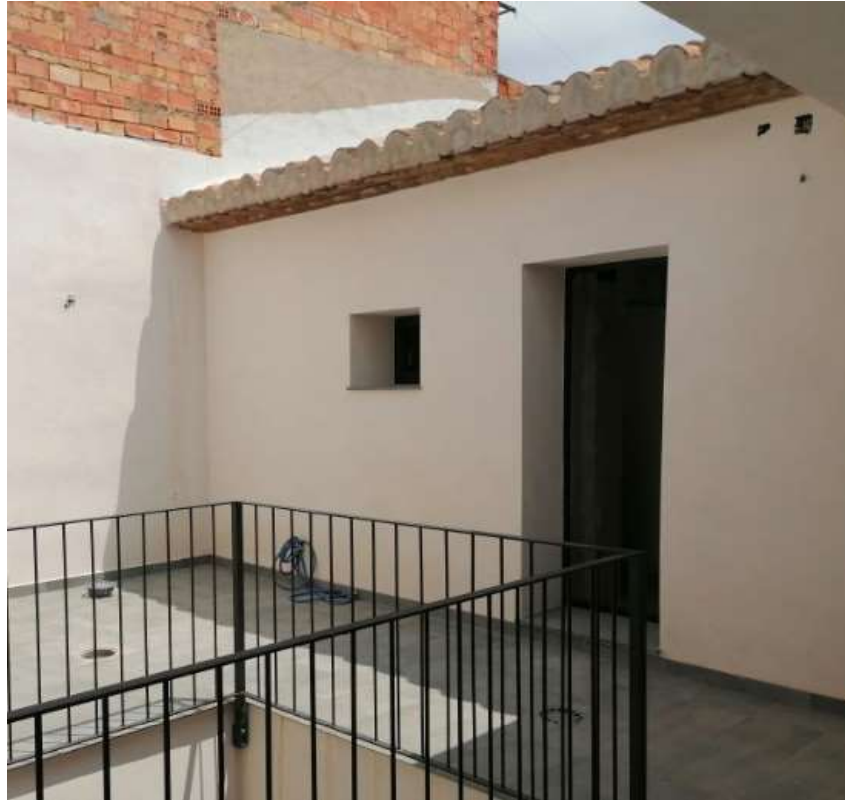
Imagen 21: Se muestra que en el faldón de la cubierta inclinada no se recoge el agua con canalón (elaboración propia)
