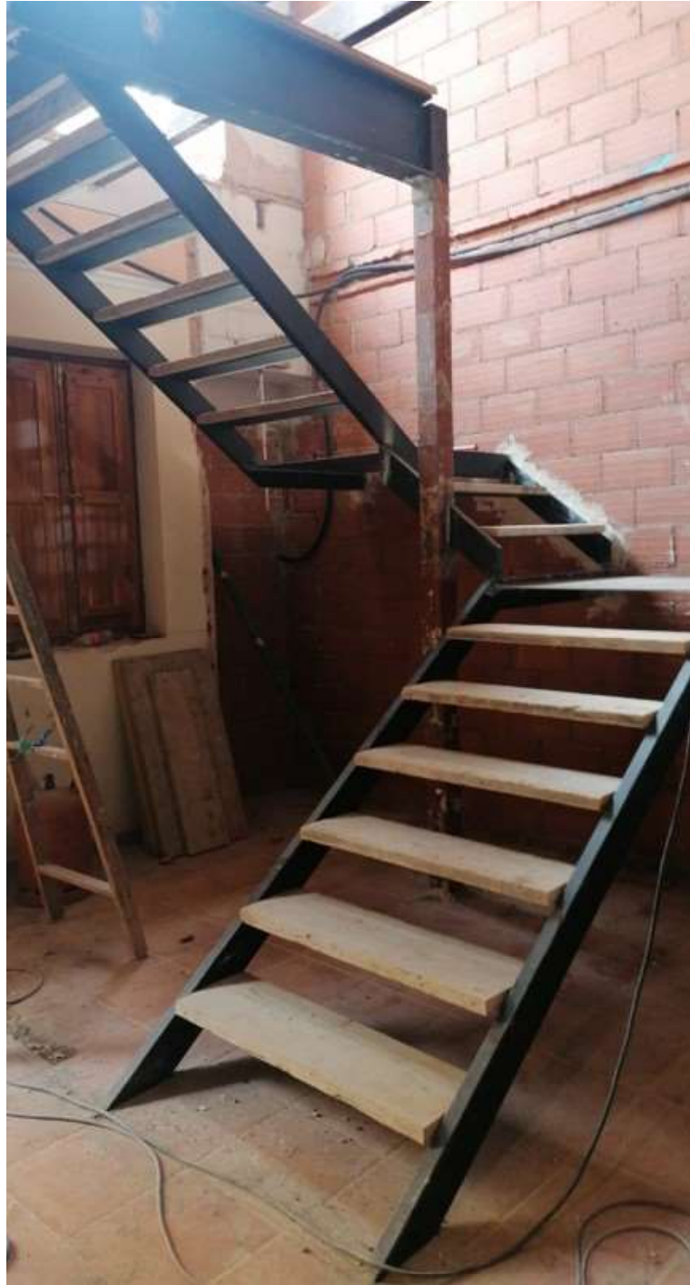
Imagen 100: Falta de protección colectiva en escalera de acceso a planta primera (elaboración propia)
