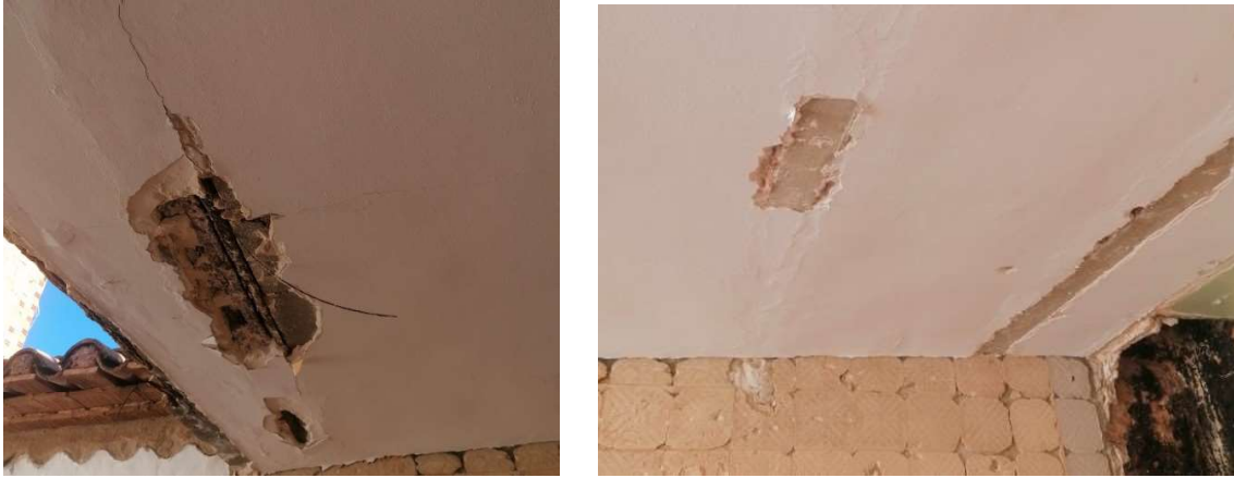
Imágenes 103 y 104: Catas en cubierta plana como comprobación de las posibles patologías en viguetas (elaboración propia)
