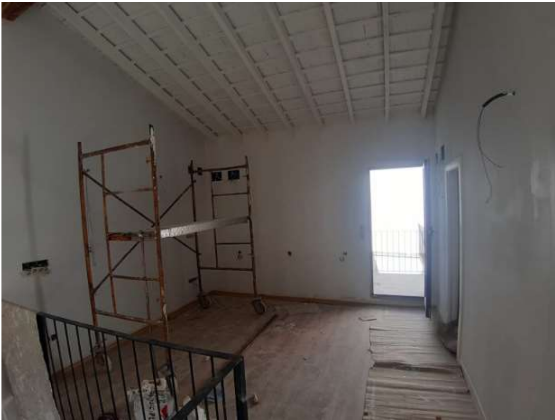
Imágenes 159, 160, 161 y 162: Estado del estar en planta primera al momento de la entrega del trabajo final de grado (elaboración propia)
