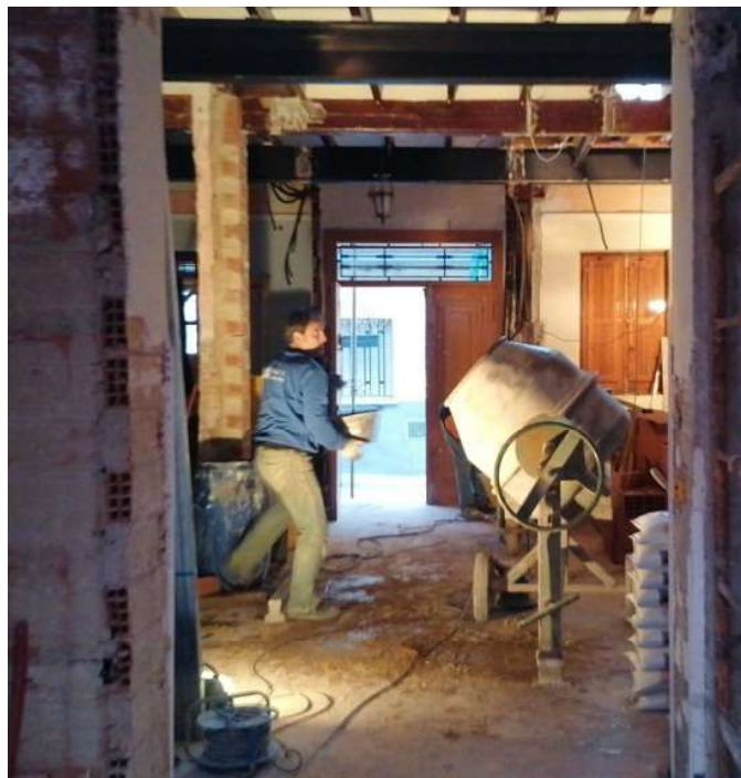
Imagen 95: Falta de protecciones individuales y mascarilla anti Covid en operario (elaboración propia)
