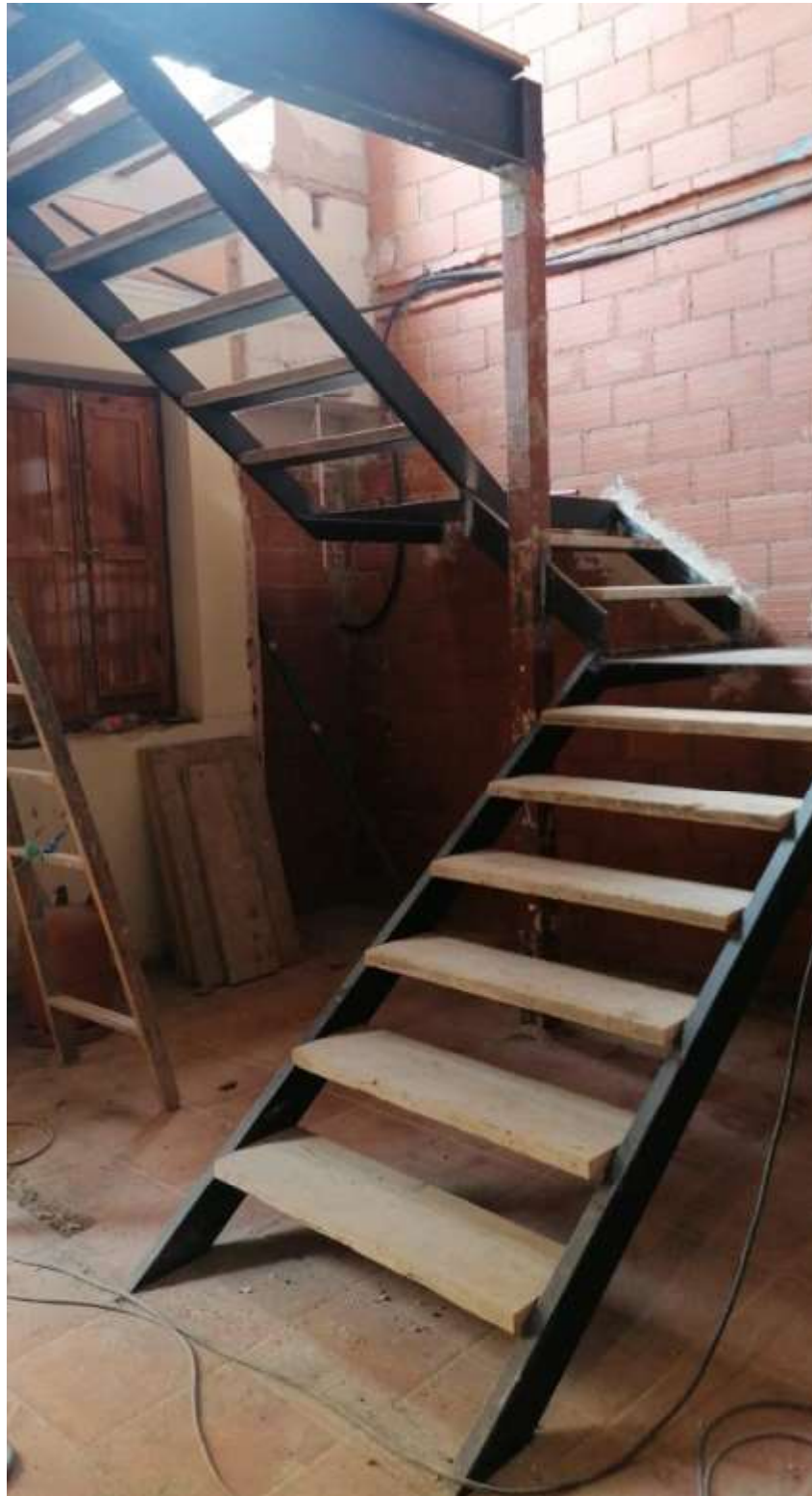
Imagen 120: Montaje de estructura metálica de escalera, peldañado en basto para su utilización (elaboración propia)
