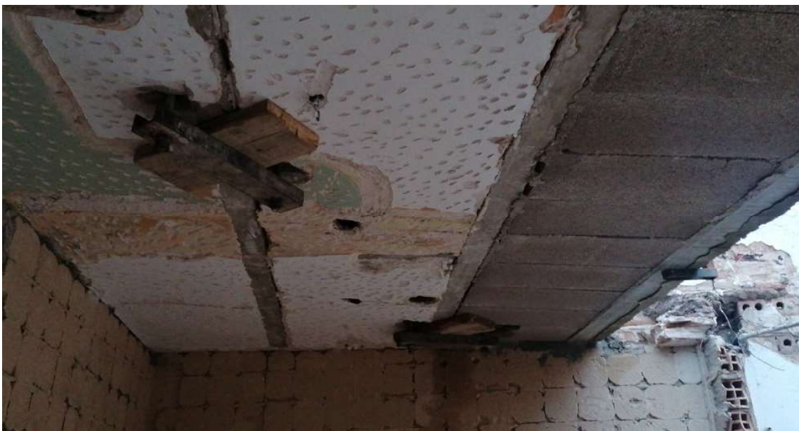
Imagen 97: Detalle de anclaje de maquinillo a forjado (elaboración propia)
