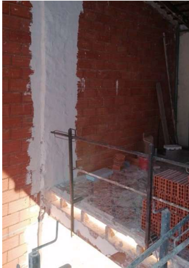
Imagen 98: Falta de tramos de rodapié en la barandilla de protección colectiva (elaboración propia)
