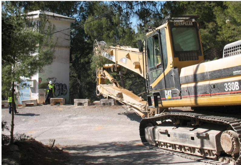
Figura 18: Encuentro de retroexcavadora con línea eléctrica aérea. (Fuente propia)
