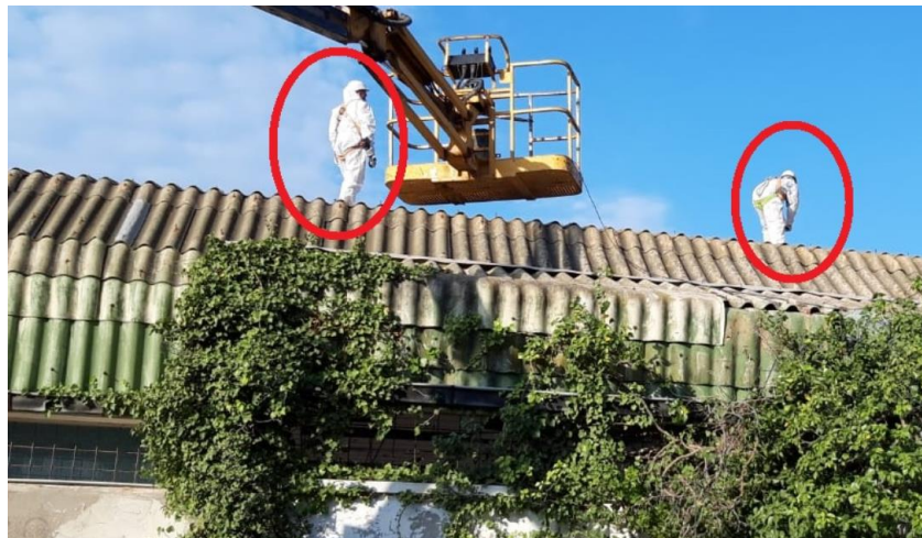
Figura 20: Operaciones de desamiantado con situación de inseguridad. (Fuente propia)
