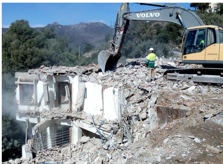
Figura 19: Operación de desescombrado peligrosa. (Fuente propia)
