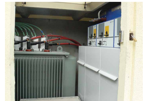
Distribución pública Compañía eléctrica EDF (Francia)
