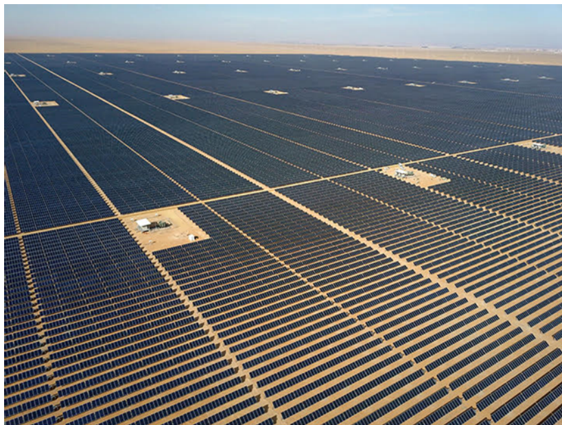
Figura 2: Planta fotovoltaica de alta capacidad de generación.
