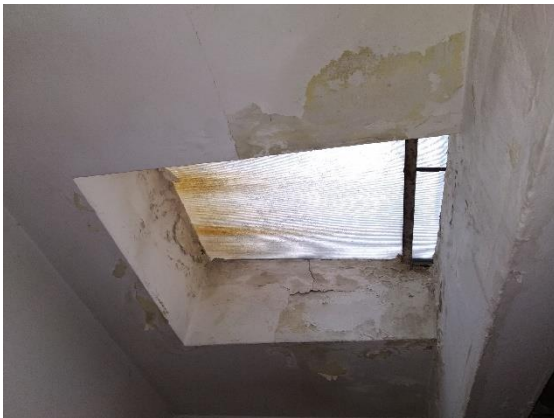
Figura 37: Zona 1 de filtración de agua. Fuente propia
