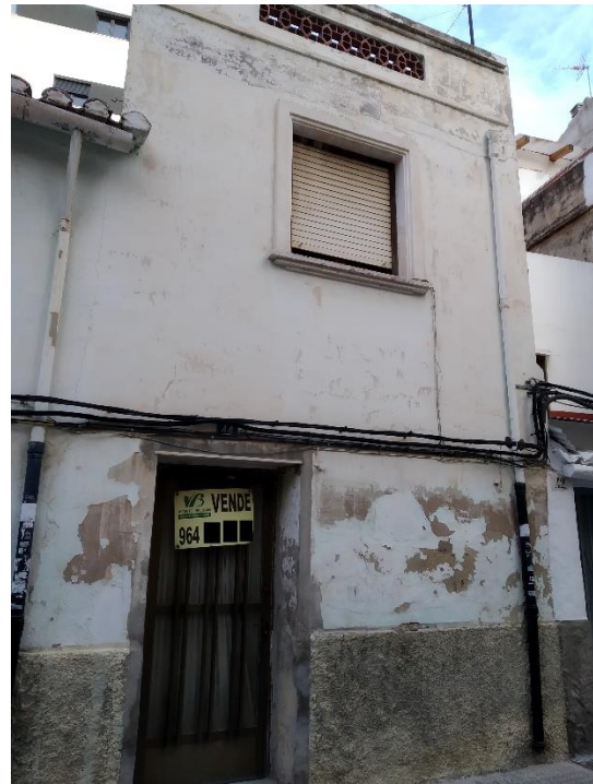
Figura 51: Estado fachada principal vivienda 44. Fuente propia
