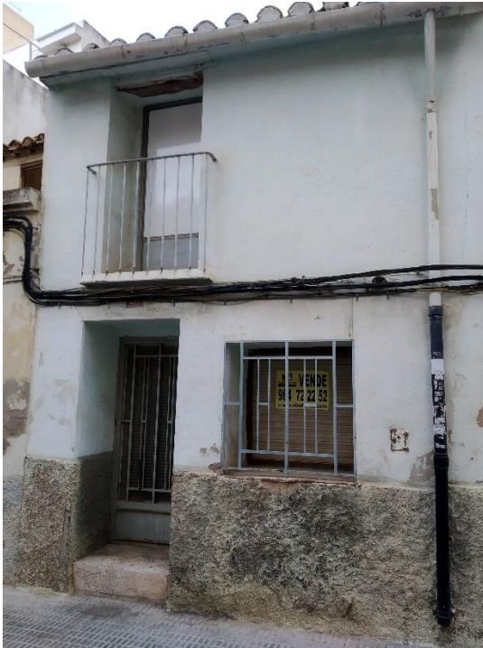
Figura 50: Estado fachada principal vivienda 46. Fuente propia
