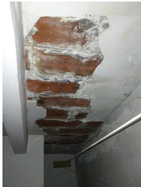
Figura 38: Zona 2 de filtración de agua: Fuente propia
