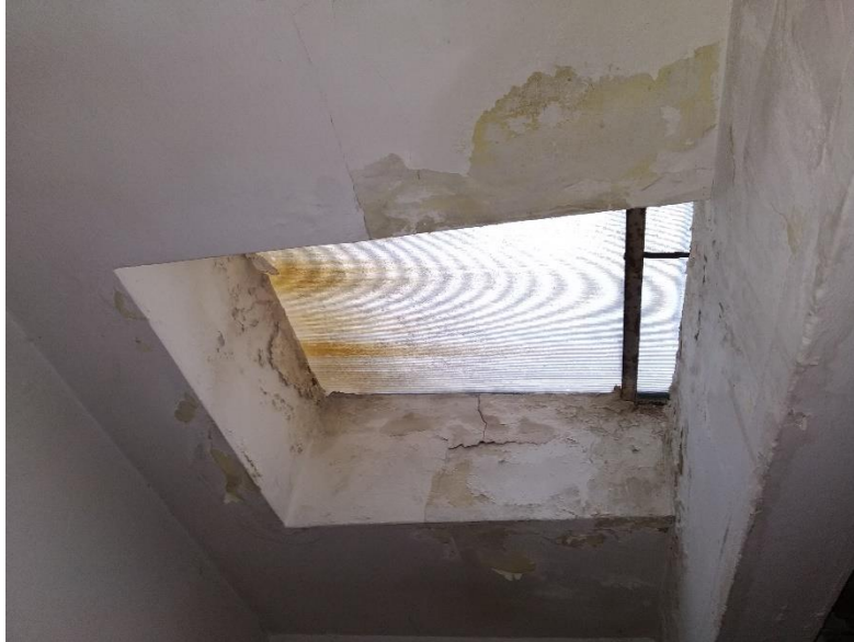
Figura 33: Deterioro claraboya. Fuente propia
