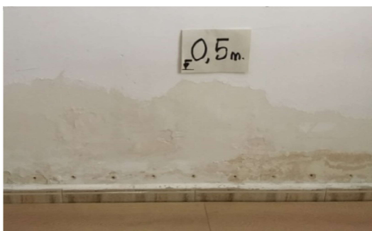
Figura 28 Humedad en tabiquería (fuente autor)
