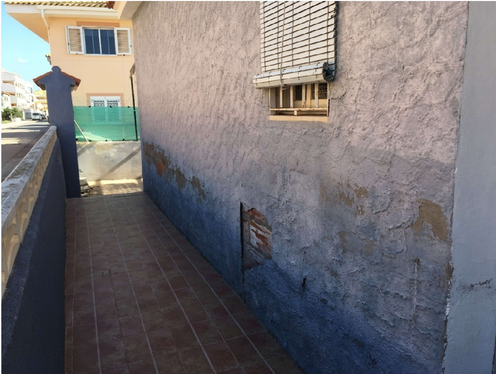
Figura 37 Humedades en la fachada, pérdida del revestimiento de mortero. (Fuente autor)
