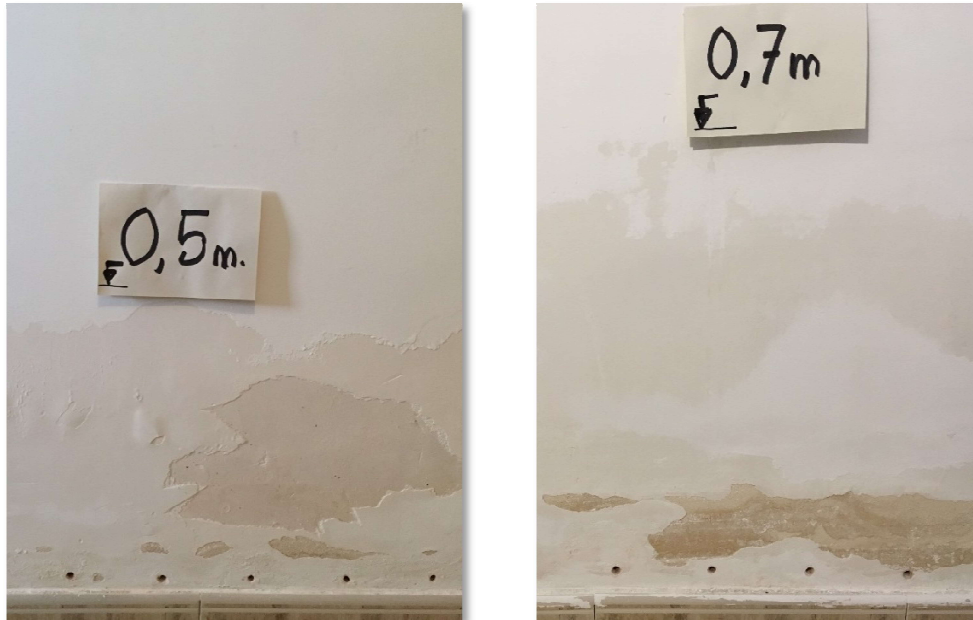
Figura 32 y 33 humedades por capilaridad en tabiquería con orientación sur (Fuente autor)
