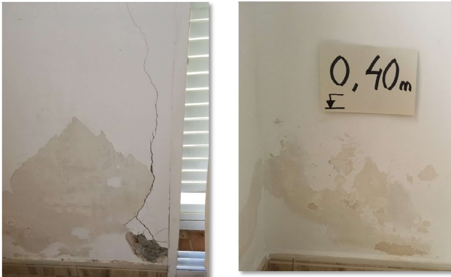
Figura 30 y 31 humedades por capilaridad en tabiquería (Fuente autor)
