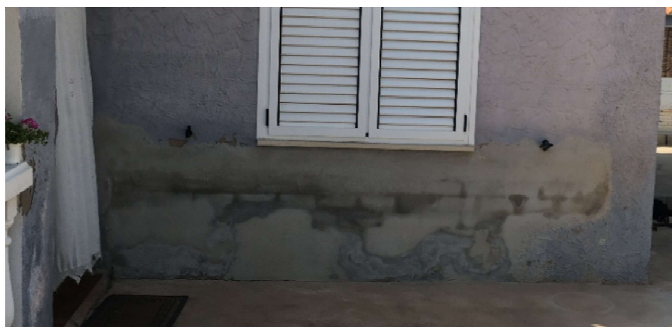
Figura 27 Humedad en fachada exterior, orientación c/ cerezo, playa de Chilches (fuente autor).
