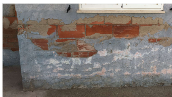
Figura 29 Humedad en fachada orientación norte (fuente autor)
