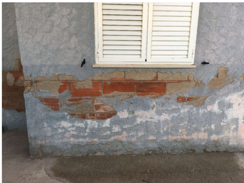
Figura 36 Humedades en la fachada, pérdida del revestimiento de mortero (Fuente autor)
