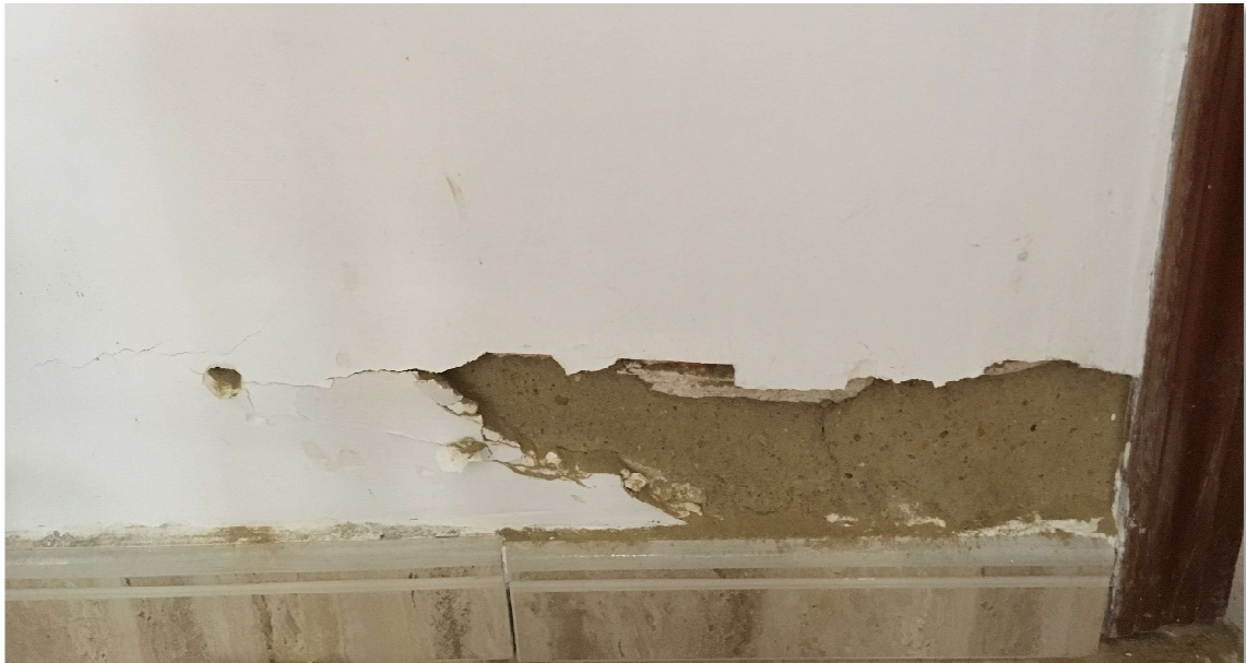
Figura 34 Humedades en el interior de la vivienda (Fuente autor)
