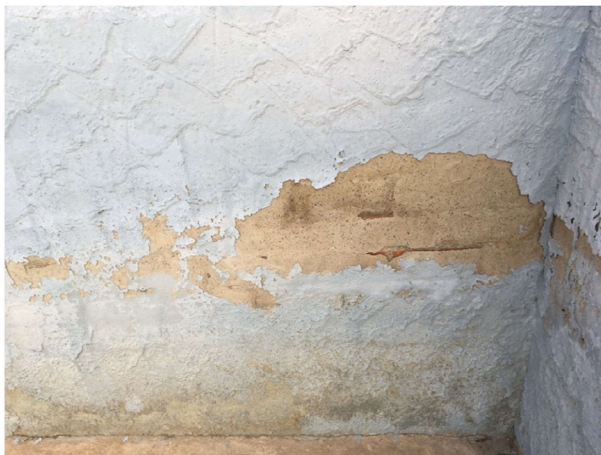
Figura 35 Humedades en la fachada, disgregación del mortero. (Fuente autor)
