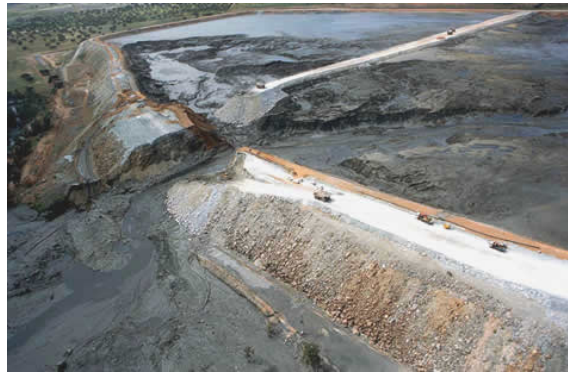
Figura 1.2: Rotura de la Presa de Aznalcollar (España) 1998.
