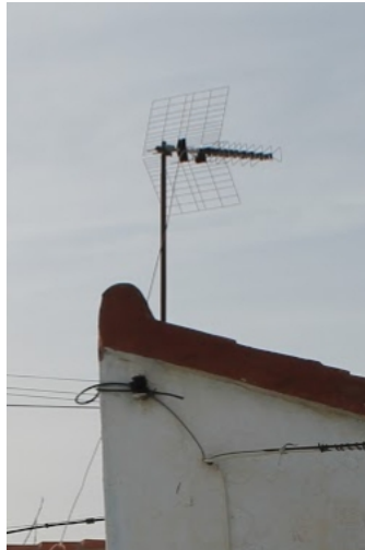
Imagen 33. Antena recepción TV y radio. (Fuente: propia)
