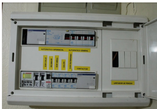
Imagen 28. Cuadro general de mando y protección actual. (Fuente: propia)
