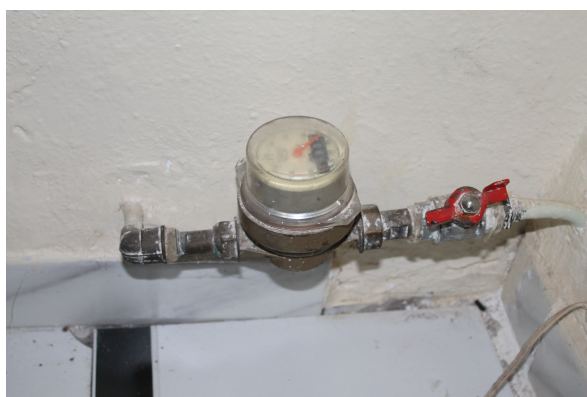
Imagen 29. Llave de paso y contador de agua. (Fuente: propia)
