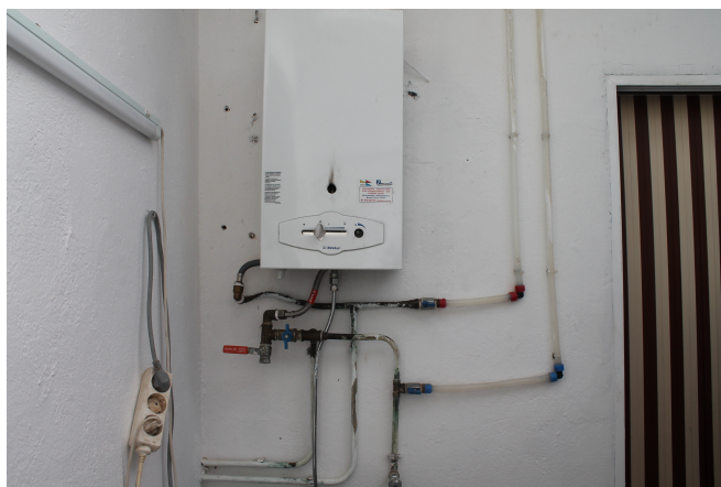
Imagen 30. Caldera de gas. (Fuente: propia)
