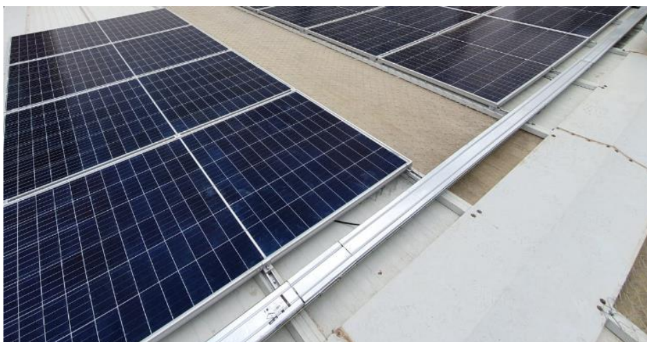
Figura 90: Fotografía de un ejemplo de instalación mostrando la sujeción a la cubierta de grecas. Fuente: Propia.
