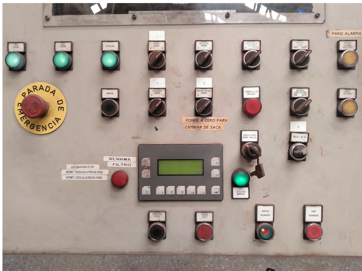
Figura 10. Botonera principal de la instalación
