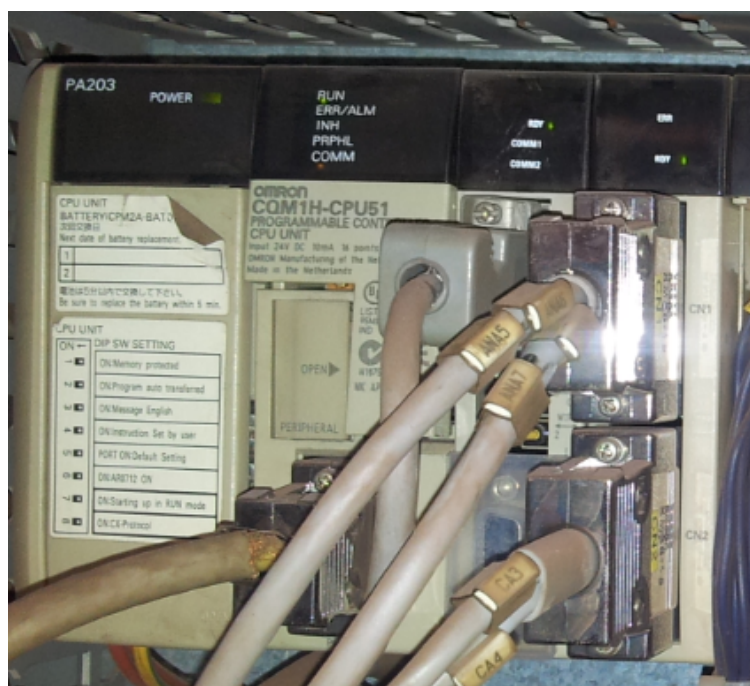
Figura 11. Detalle del CPU actual en la instalación
