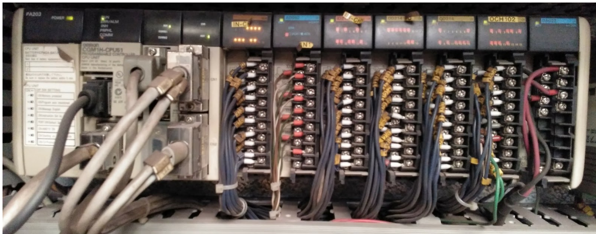
Figura 6. PLC actual y a su lado las tarjetas de E/S.
