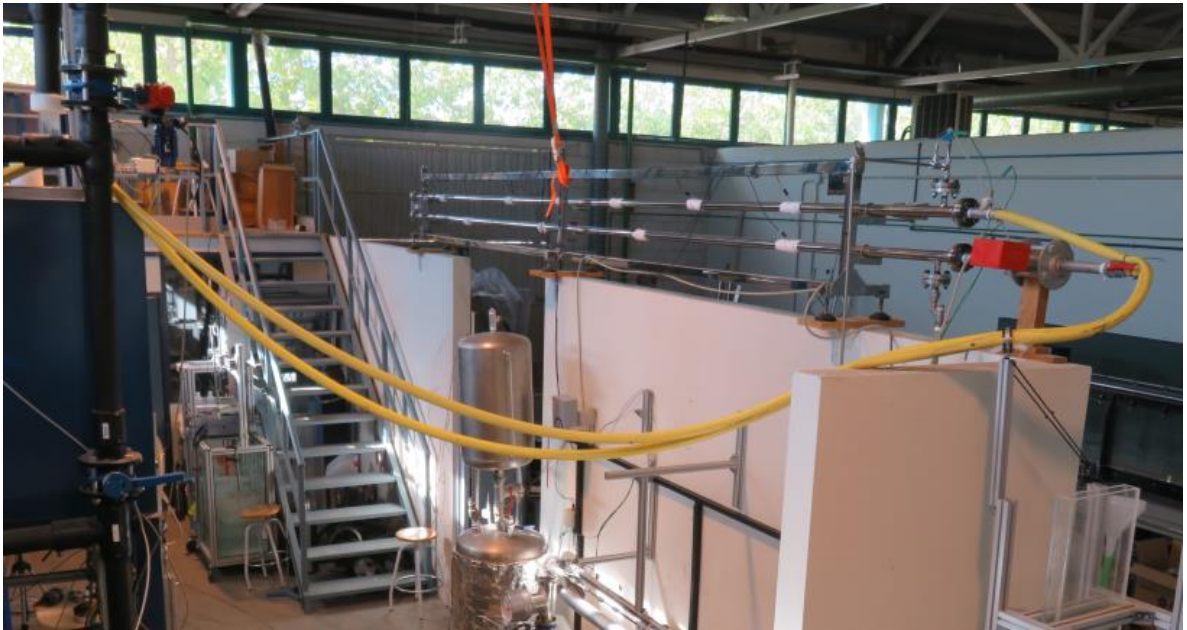
Figura 25. Imagen del intercambiador de calor en la instalación.
