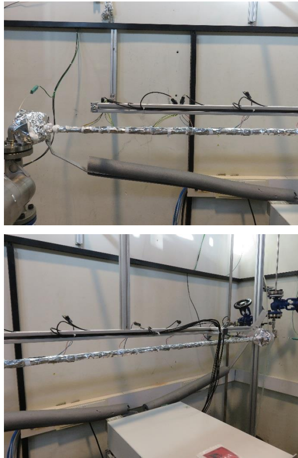
Figura 33. Imágenes de las termorresistencias de superficie en la zona de calentamiento de la instalación.
