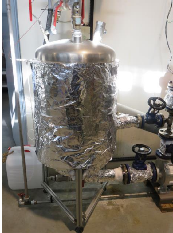
Figura 16. Imagen del depósito principal en la instalación.
