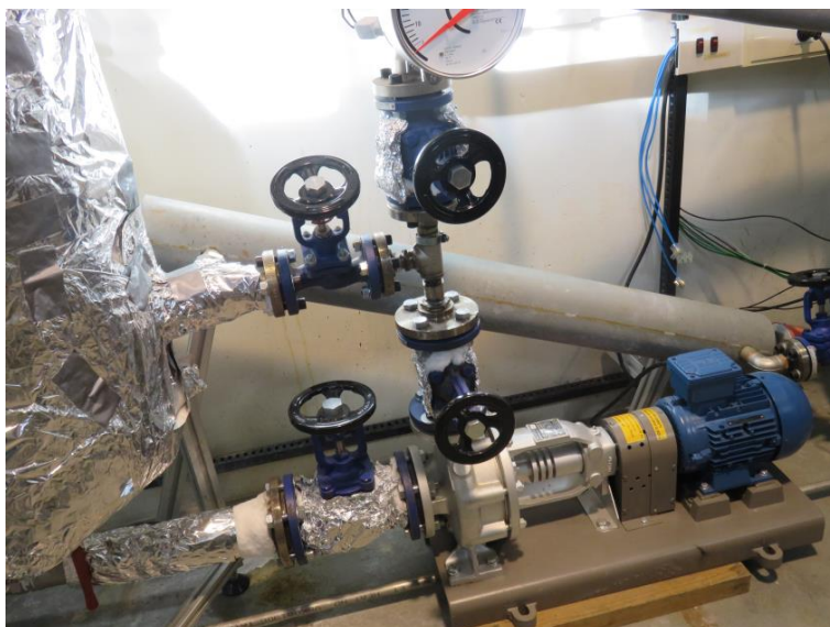
Figura 27. Imagen del precalentador en la instalación.
