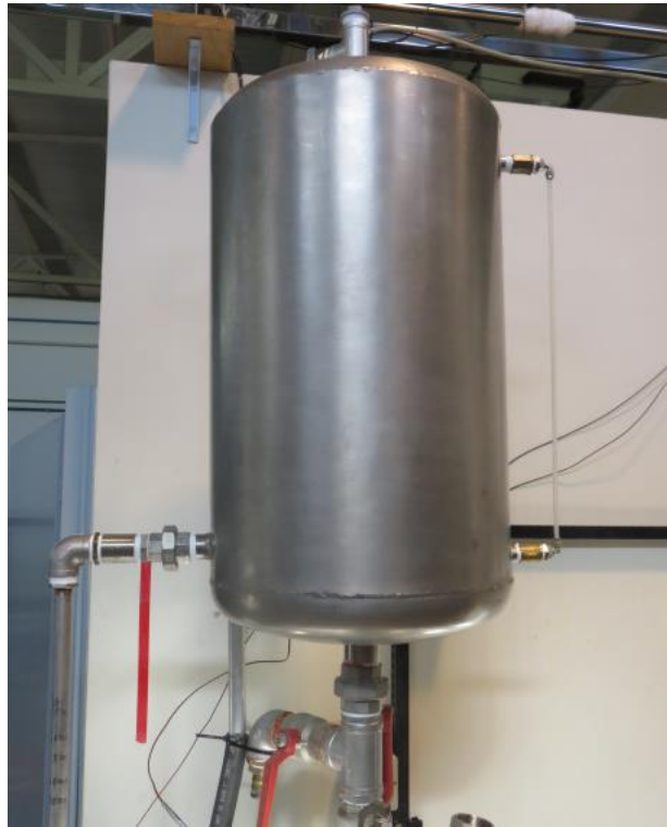
Figura 29. Imagen depósito secundario en la instalación.
