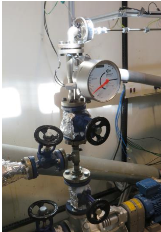
Figura 21. Imagen del caudalímetro en la instalación.
