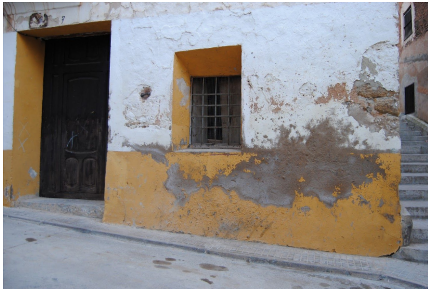
Figura 63. Humedad por capilaridad en fachada principal. (Fuente: Propia)
