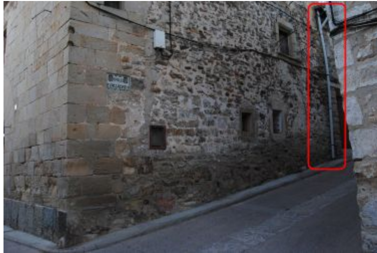
Figura 51. Bajante pluvial que desagua en la calle Valladar. (Fuente: Propia)
