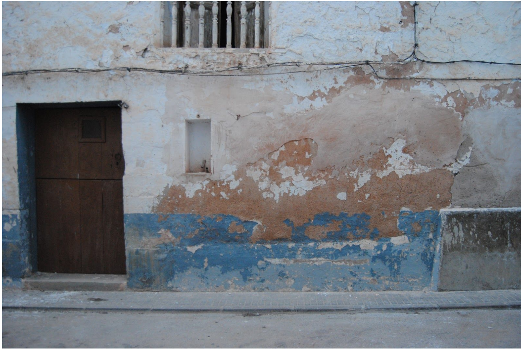
Figura 5. Humedades por capilaridad en fachada principal. (Fuente: Propia)
