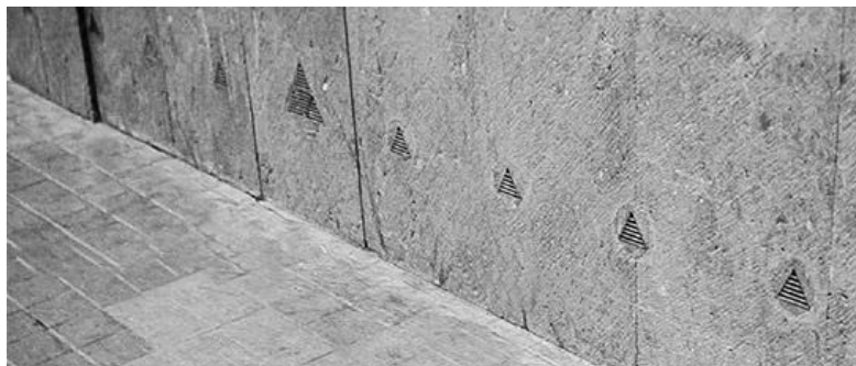
Figura 30. Sifones atmosféricos instalados en fachada. (Fuente: Pinterest)
