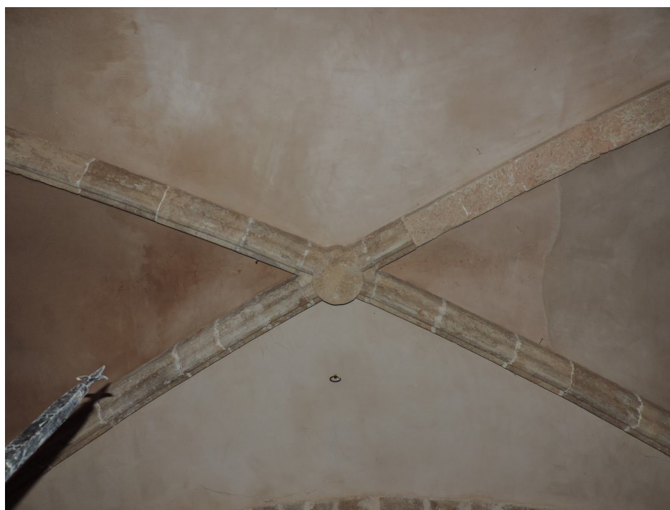
Figura 9. Humedades por condensación en una bóveda. (Fuente: Altaba Tena, Pablo)
