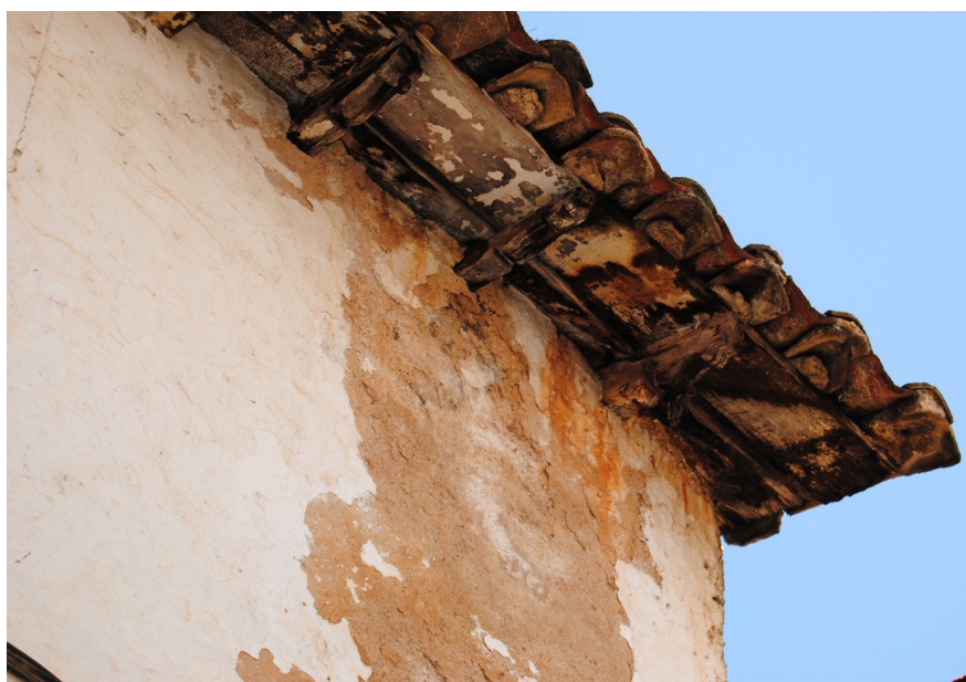
Figura 10. Humedad por filtración en fachada bajo cubierta. (Fuente: Propia)
