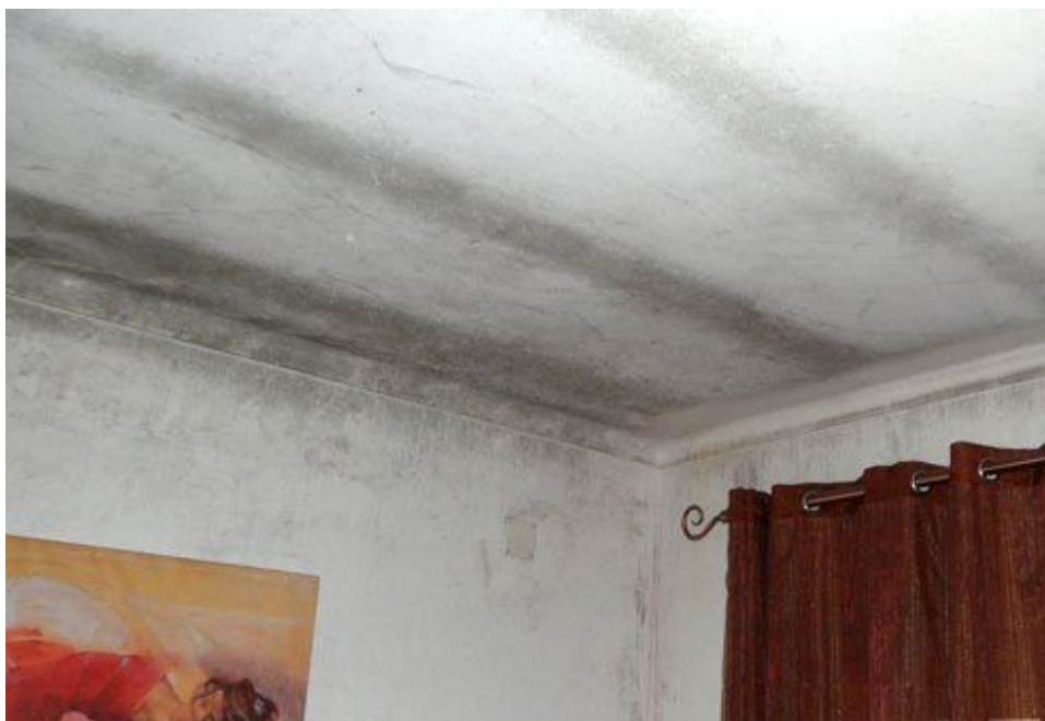
Figura 8. Humedad por condensación en la zona de las viguetas. (Fuente: Prohucon)
