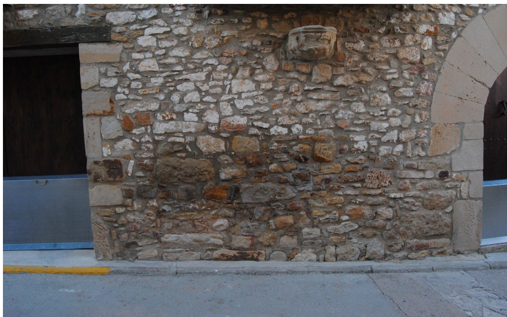
Figura 4. Humedades por capilaridad en paramento exterior. (Fuente: Propia)
