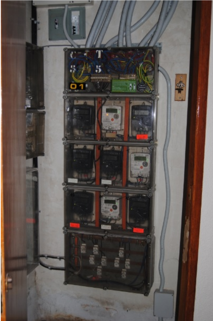
Suministro electrico. Cuadro de contadores. [Ref. IN005]
