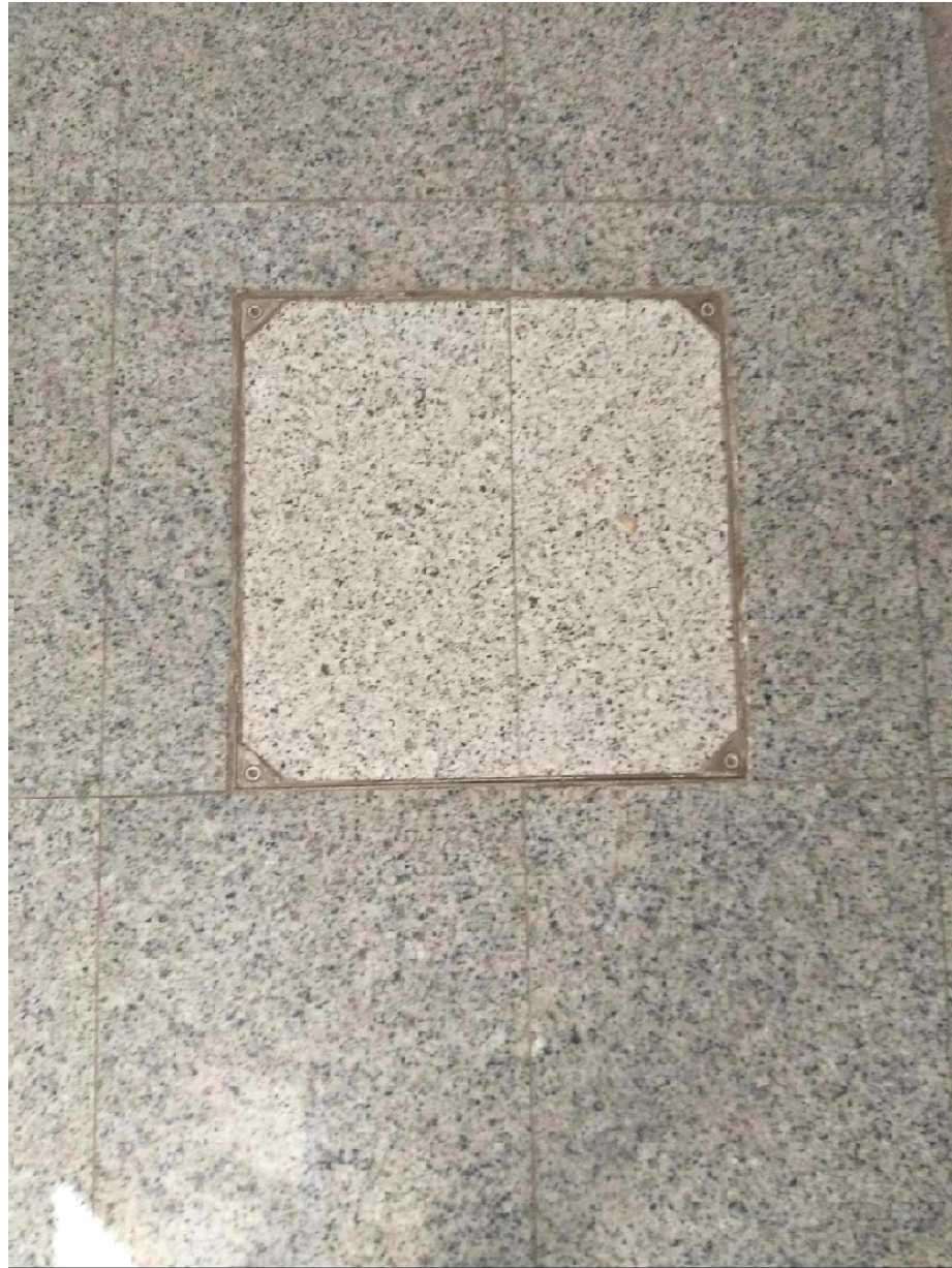
Evacuación de aguas. Arquetas. [Ref. IN003]
