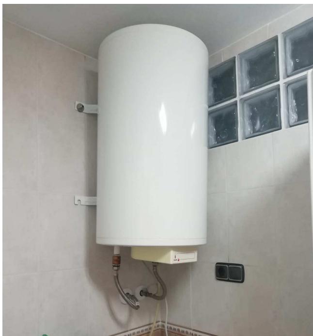
Figura 107: Termo eléctrico. Fuente propia
