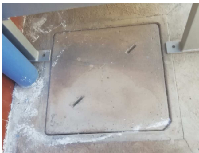
Figura 25: Arqueta con conexión a la bajante pluvial. Fuente propia
