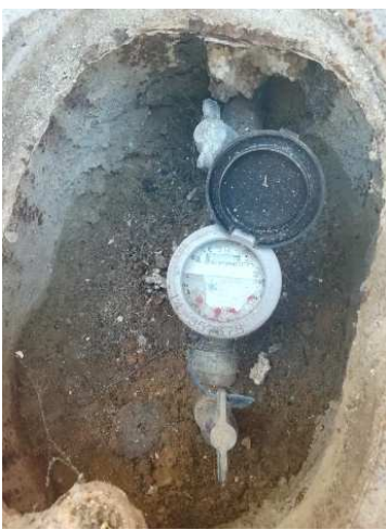
Figura 22: Llaves del contador de agua. Fuente propia
