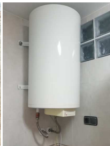
Figura 23: Termo eléctrico. Fuente propia
