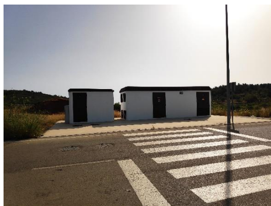
Imagen 11. Centro de transformación (Propia Autoría)
