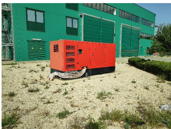
Imagen 10. Grupo electrógeno (Propia Autoría)
