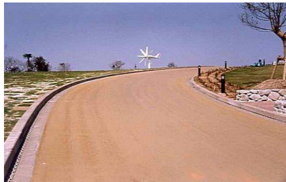
Figura 3.1. Suelo de tierra compactada. (FUENTE: www.polypavement.com )
