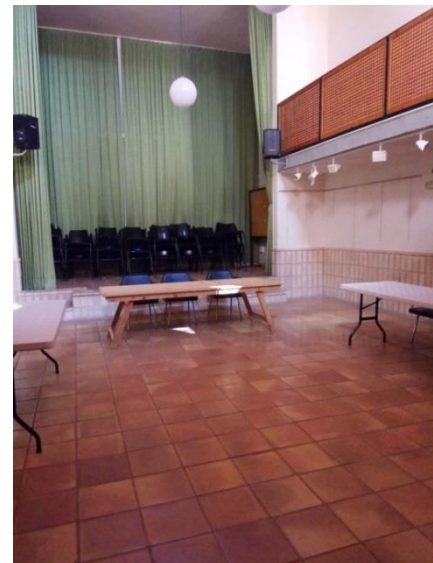
Fig. 173 Pavimento salón de actos. Fuente: Fotografía propia realizada, en el lugar de consulta 10/04/2019
