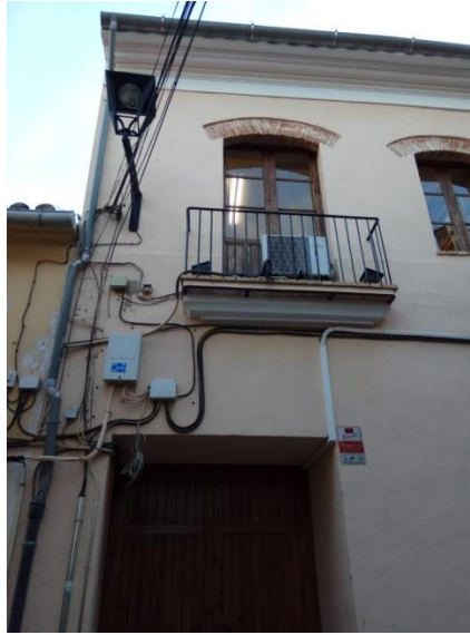
Fig. 187 Caja eléctrica. Fuente: Fotografía propia realizada, en el lugar de consulta 28/01/2019
