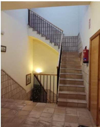
Fig. 152 Cuarto y quinto tramo. Fuente: Fotografía propia realizada, en el lugar de consulta 28/02/2019
