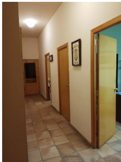
Fig. 135 Tabique ladrillo del 7. Fuente: Fotografía propia realizada, en el lugar de consulta 28/02/2019
