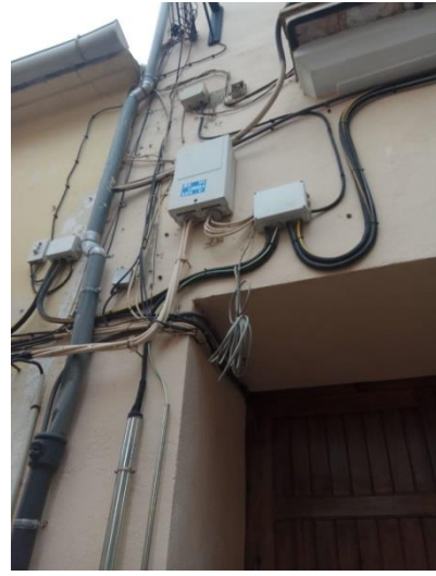
Fig. 215 Cajas eléctricas. Fuente: Fotografía propia, realizada en el lugar de consulta 24/04/2019
