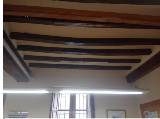
Fig. 208 Flexión viguetas. Fuente: Fotografía propia, realizada en el lugar de consulta 20/06/2019
