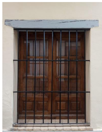
Fig. 209 Fisuración dintel. Fuente: Fotografía propia, realizada en el lugar de consulta 24/04/2019
