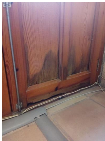
Fig. 196 Deterioro 2 carpintería ayuntamiento. Fuente: Fotografía propia realizada, en el lugar de consulta 27/06/2019
