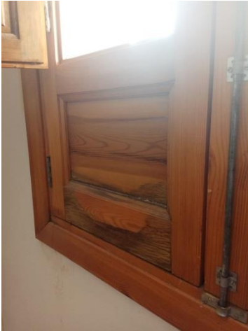
Fig. 198 Deterioro 4 carpintería salón de actos. Fuente: Fotografía propia realizada, en el lugar de consulta 10/04/2019
