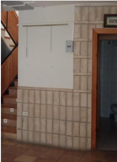
Fig. 164 Zócalo y pintura interior. Fuente: Fotografía propia realizada, en el lugar de consulta 10/04/2019
