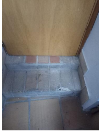
Fig. 210 Rotura peldaño. Fuente: Fotografía propia, realizada en el lugar de consulta 10/04/2019
