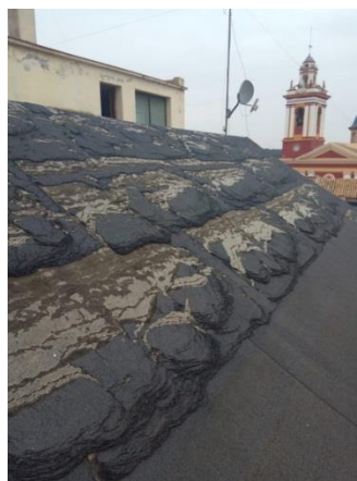
Fig. 206 Estado cubierta. Fuente: Fotografía propia, realizada en el lugar de consulta 06/03/2019
