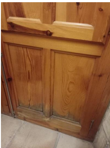
Fig. 195 Deterioro 1 carpintería ayuntamiento. Fuente: Fotografía propia realizada, en el lugar de consulta 27/06/2019
