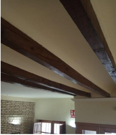
Fig. 207 Fisuración viguetas. Fuente: Fotografía propia, realizada en el lugar de consulta 20/06/2019
