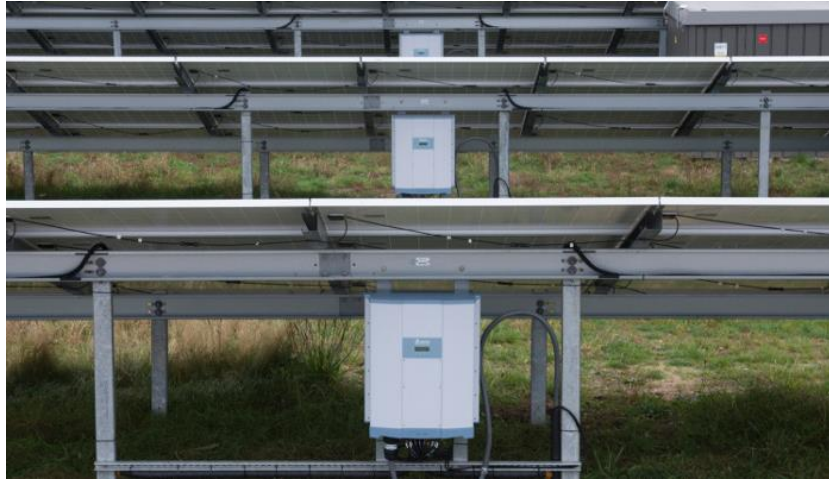
Figura 18. Inversor de rama in situ
