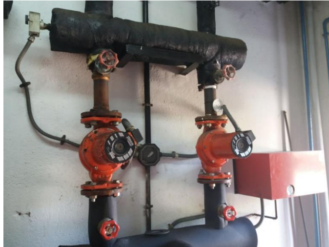
Imagen 34. Sistema de bombeo.
