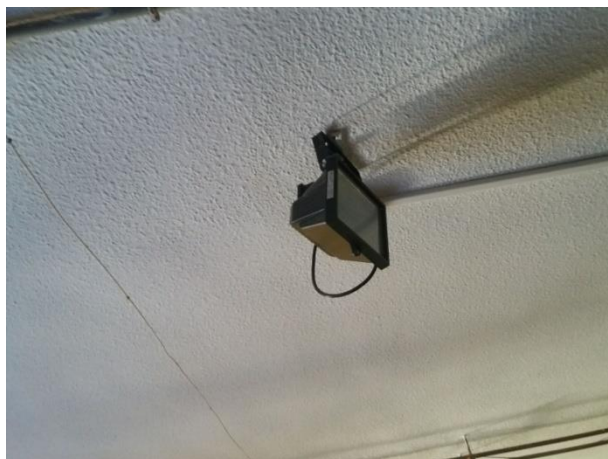
Imagen 13. Foco halógeno vestíbulo.
