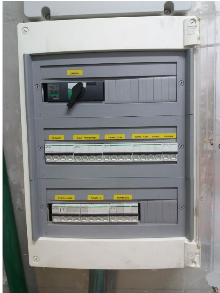
Imagen 8. Cuadro general de baja tensión.
