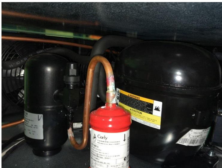
Figura 30. Foto del compresor, del depósito y del filtro de humedad.
