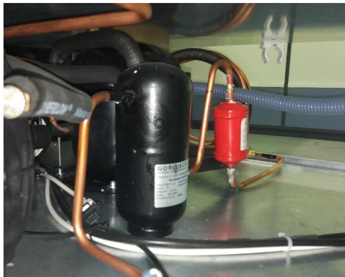
Figura 32. Foto del depósito y filtro de humedad. Al fondo se puede observar la sección de tubería en forma de “cola de cerdo”.
