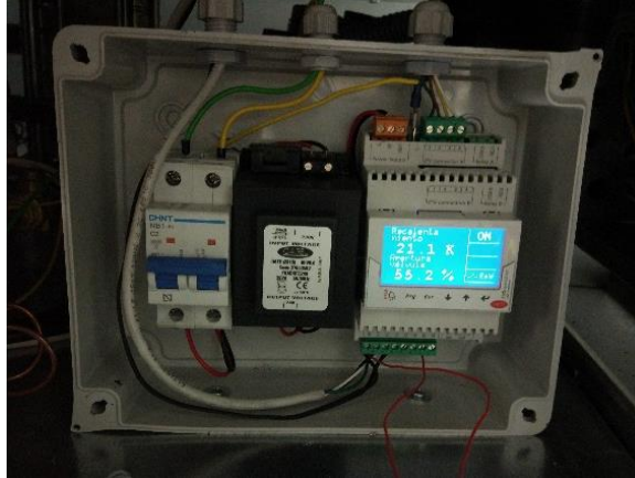
Figura 34. Alimentación de la válvula de expansión.
