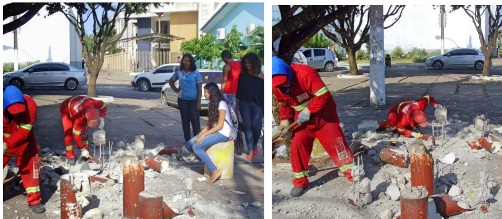
Figura 3. destruição dos bancos pela Semur
