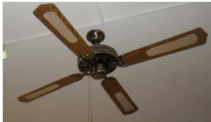
Imagen 15. Ventilador de techo.
