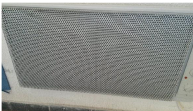
Imagen 12. Radiador eléctrico de la marca HAVERLAND de 1200 W instalado en una de las aulas.
