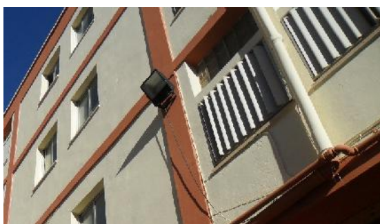
Imagen 10. Lámparas de 450W instaladas al aire libre con el fin de iluminar la zona recreativa del Colegio.
