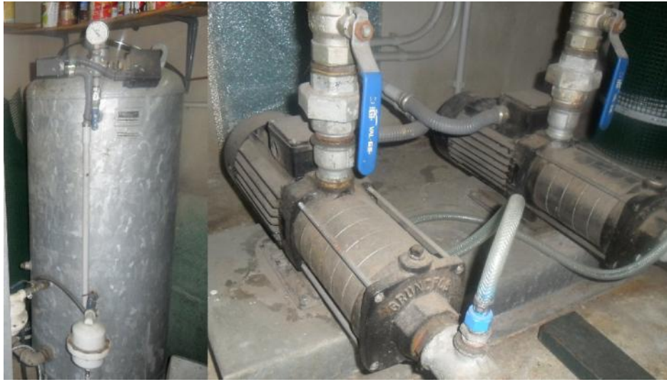
Imagen 11. Acumulador hidroneumático y grupo de bombeo.
