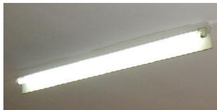
Imagen 5. Luminaria con tubo fluorescente T8 de 0.6 metros y 18W.
