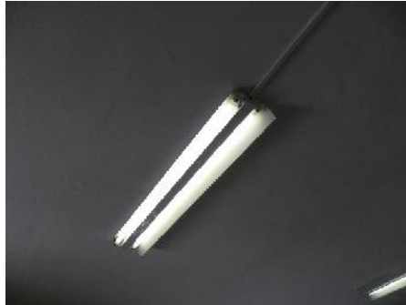
Imagen 7. Pantalla de tubos fluorescentes T8 de 2x36 W
