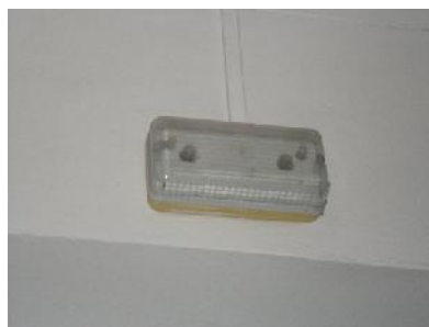
Imagen 9. Conjunto de luces de emergencia.
