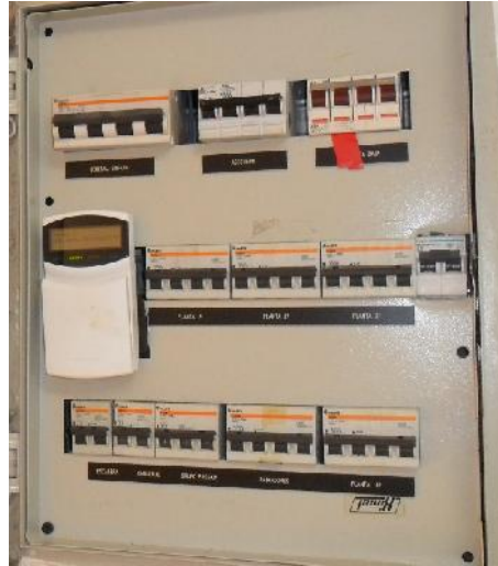
Imagen 16. Analizador de redes conectado en el cuadro general de la instalación
