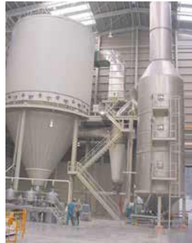
Figura 7.8: Sistema de depuración de gases de ATM.
