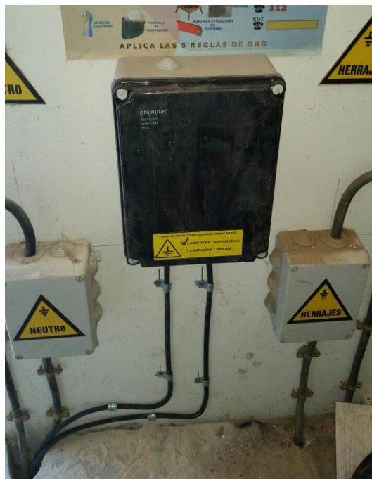
Imagen 20. Cajas de seccionamiento de tierras, a la izquierda de neutro, a la derecha de herrajes
