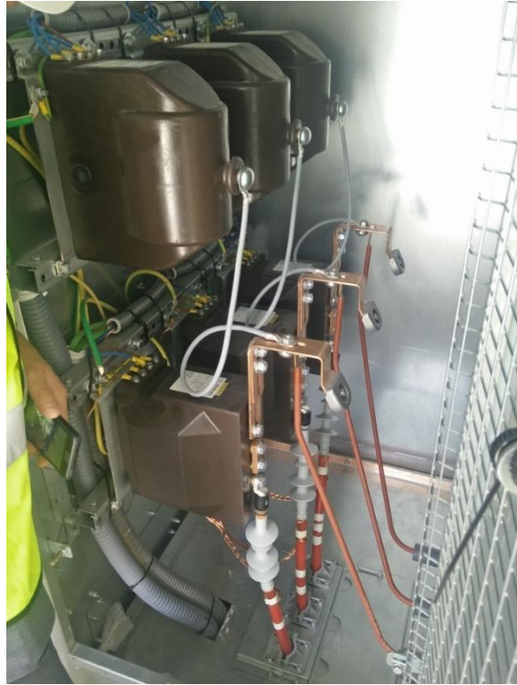
Imagen 19. Interior de la celda de medida del CTC de Mercadona en calle senda pescadors de Villa-Real
