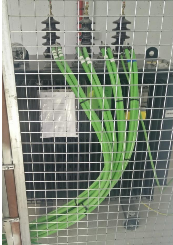
Imagen 17. Conductores de interconexión entre el transformador y el cuadro de BT
