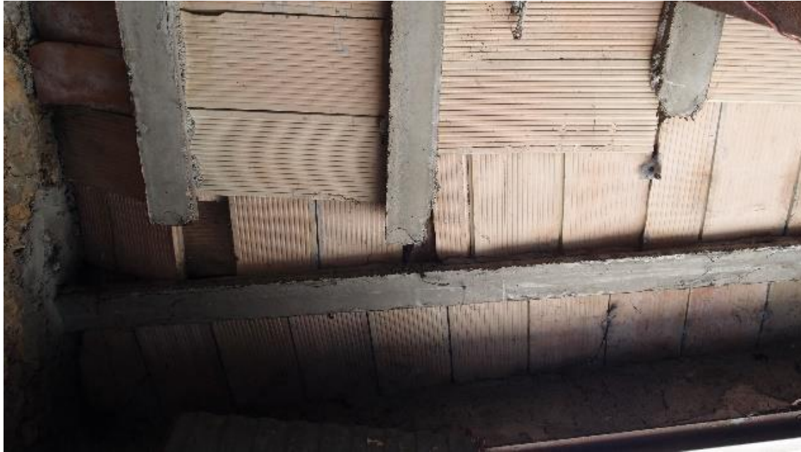
Parte de forjado deteriorado
