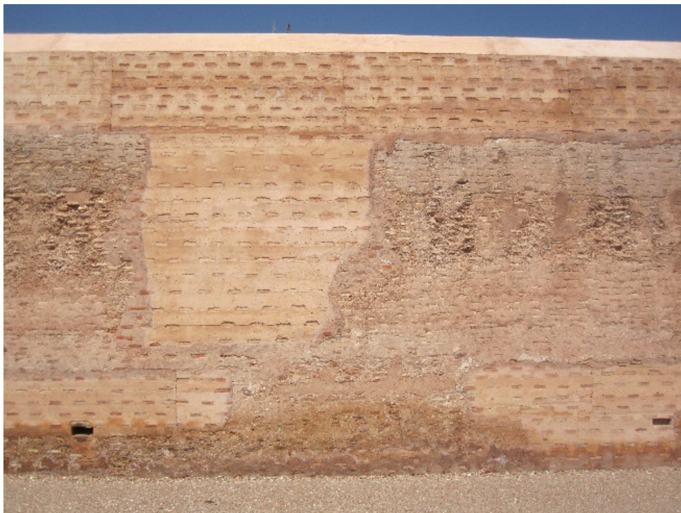
Figura 28. Lienzo sur, correspondiente a donde estaba situado el cementerio, donde se aprecia la reincorporación de la tapia valenciana en la coronación y ocultando los huecos que formaban los nichos en la parte inferior. Fuente: Propia.
