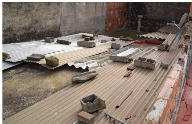
Figura 109. Estado de la cubierta. Fuente: Propia.
