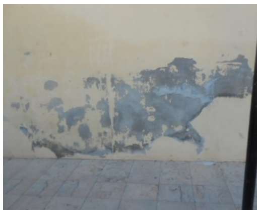
Figura 48. Desprendimiento de la pintura en el lateral del ayuntamiento. Fuente: Propia.
