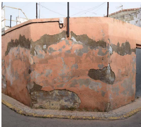
Figura 46. Humedades hasta una altura de más de 1,8m en muro de la calle Virgen del Carmen. Fuente: Propia.
