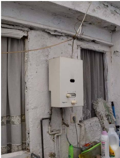
Figura 123. Caldera de gas y punto de suministro de AFCH. Fuente: Propia.
