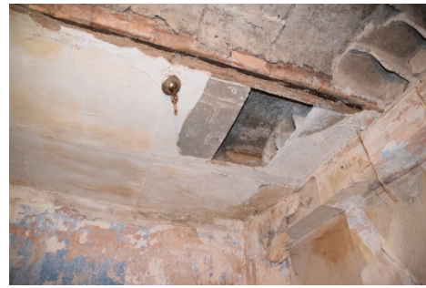
Figura 132. Punto donde más afectado se encuentra el forjado. Fuente: Propia.
