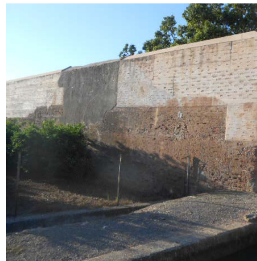
Figura 12. En la actualidad está relleno con tapial, seguramente durante las obras de 2008. Fuente: Propia.
