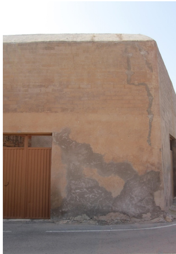
Figura 32. También en el lienzo Norte se ha abusado de la propiedad de la muralla. Fuente: Propia
