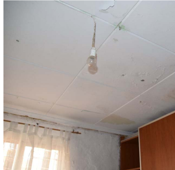
Figura 99. Falso techo de escayola que aún se conserva en el dormitorio principal. Fuente: Propia
