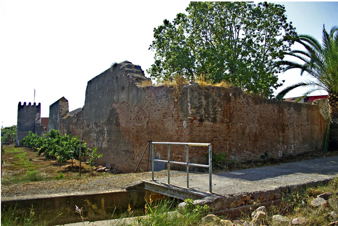
Figura 22. Estado de la muralla tras las tormentas de 1987. Fuente: http://mapio.net/pic/p-5271869/
