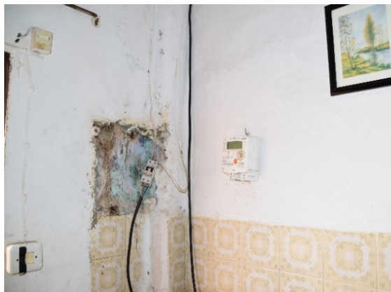
Figura 125. Contador de luz y "cuadro de luces". Fuente: Propia.
