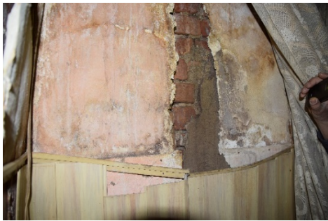
Figura 131. Muestra de como se encuentran algunos de los muros de la vivienda. Fuente: Propia.
