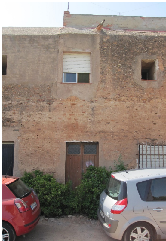
Figura 31. En la foto se puede ver la apertura indiscriminada de huecos en el lienzo Este Fuente: Propia
