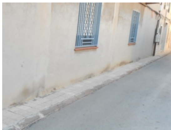
Figura 49. Marcas de humedad en la base del muro en la calle Cueva Santa. Fuente: Propia.
