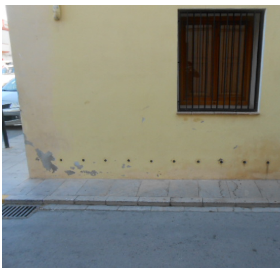
Figura 37. Colocación en la base del muro de tubos de condensación para eliminar la humeada del muro. Fuente: Propia.
