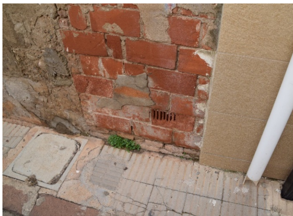
Figura 47. Eflorescencias por la expulsión de sales debido a la humedad del muro en la calle San Roque. Fuente: Propia.
