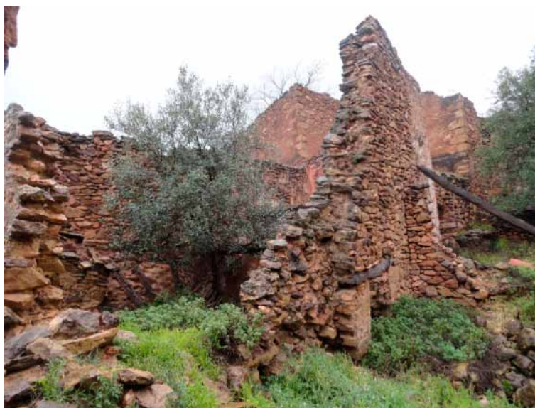
Muros exteriores de viviendas y corrales en estado de ruina
