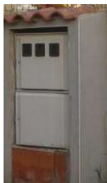
Caixa General de Protecció
