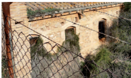
Detalle de la mampostería del conjunto de viviendas adosadas a la fábrica
