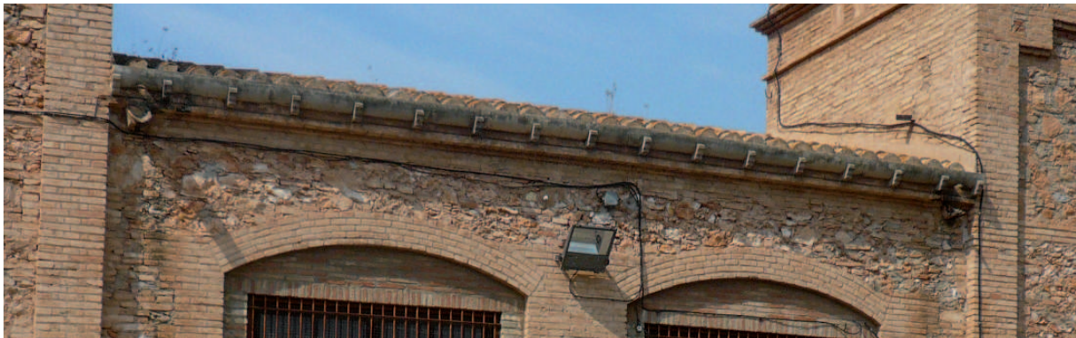
Detalle de la canaleta, sujeciones y desagüe de la central Fuente: Autor
