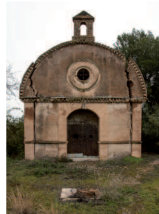
En la parte inferior de la imagen se puede ver la trampilla del aljibe. Fisuras en el hastial principal
