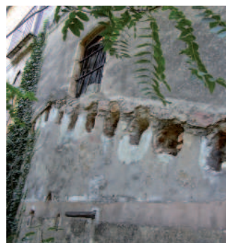
Molí la Bisbal_ Restos de estructura de cubierta_
