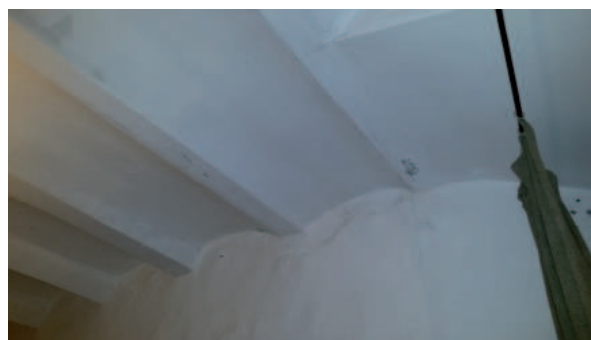
Detalle de revoltones cerámicos y viguetas empotradas en el cerramiento de terreno natural.
