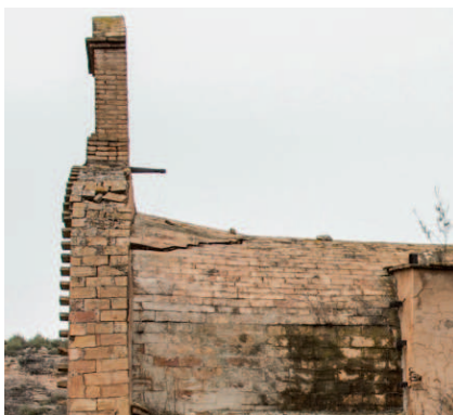
Desplome de la bóveda
