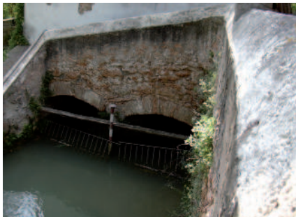
filtro de entrada del canal
