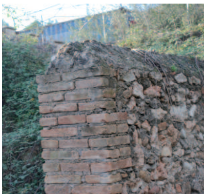
Detalle, machón de ladrillo cerámico macizo con muro de mampostería de cal y canto
