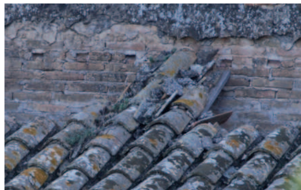
Detalle del derrumbe de la cubierta de la casa del encargado
