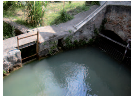
Esclusa de aliviadero del canal
