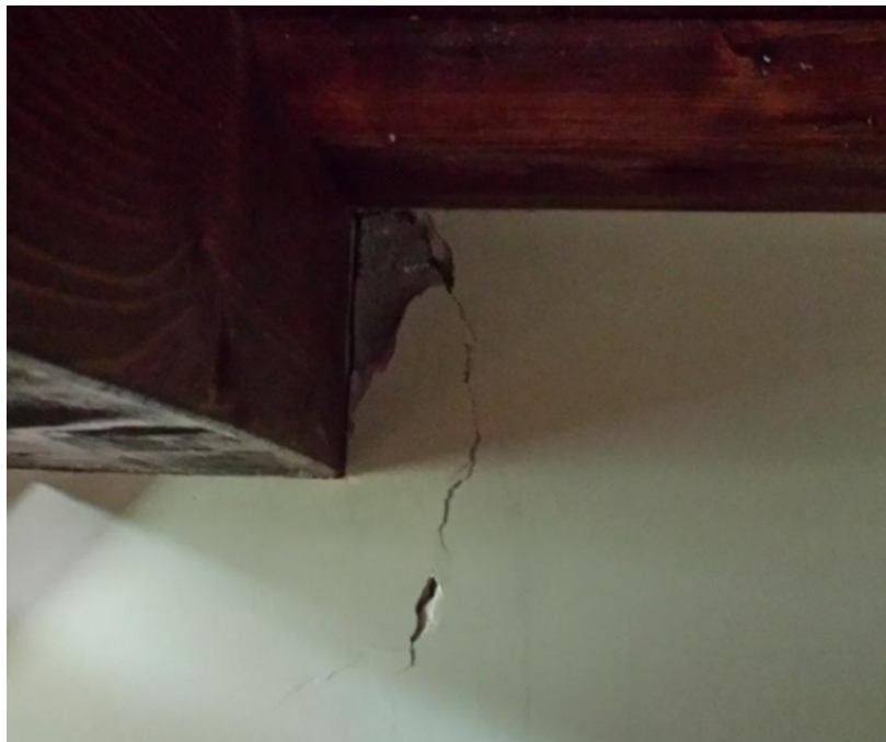
Imagen 4.1. Grieta altillo de madera.
