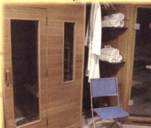
Circuito de saunas
