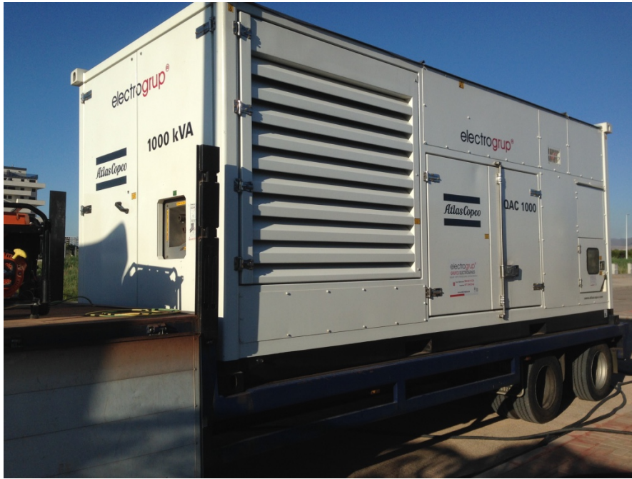
Ilustración 1. Grupo electrógeno ATLAS COPCO 1000 kVA
