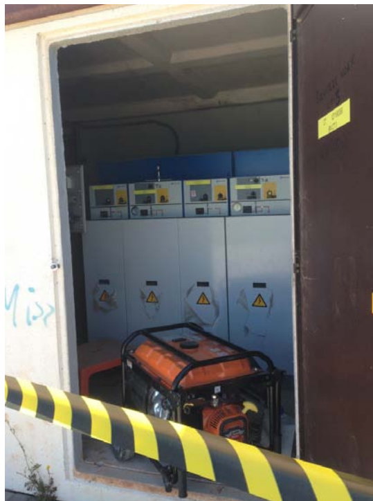
Ilustración 2. Grupo electrógeno instalado de apoyo
