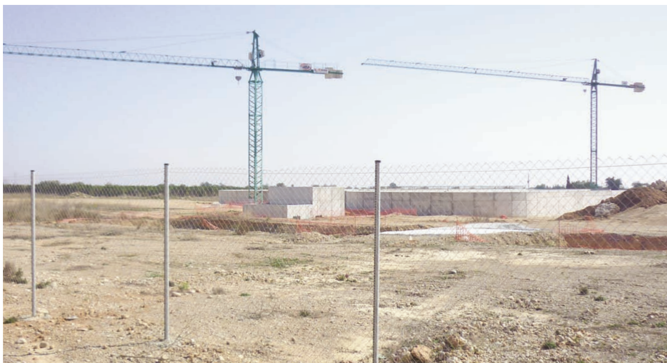
Esta és la nostra inacabada i aturada depuradora: un terreny erm i quatre planxes de formigó
