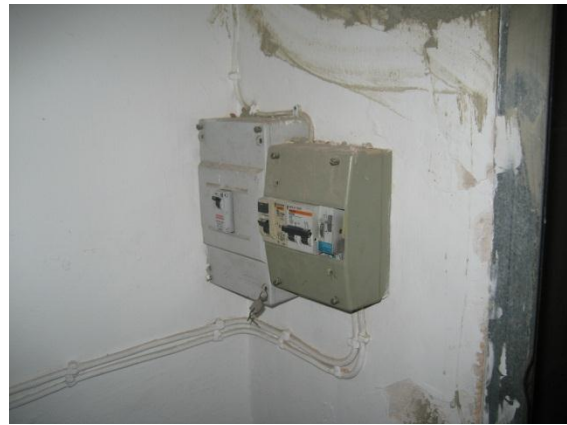
Ilustración 15. Cuadro de protección
