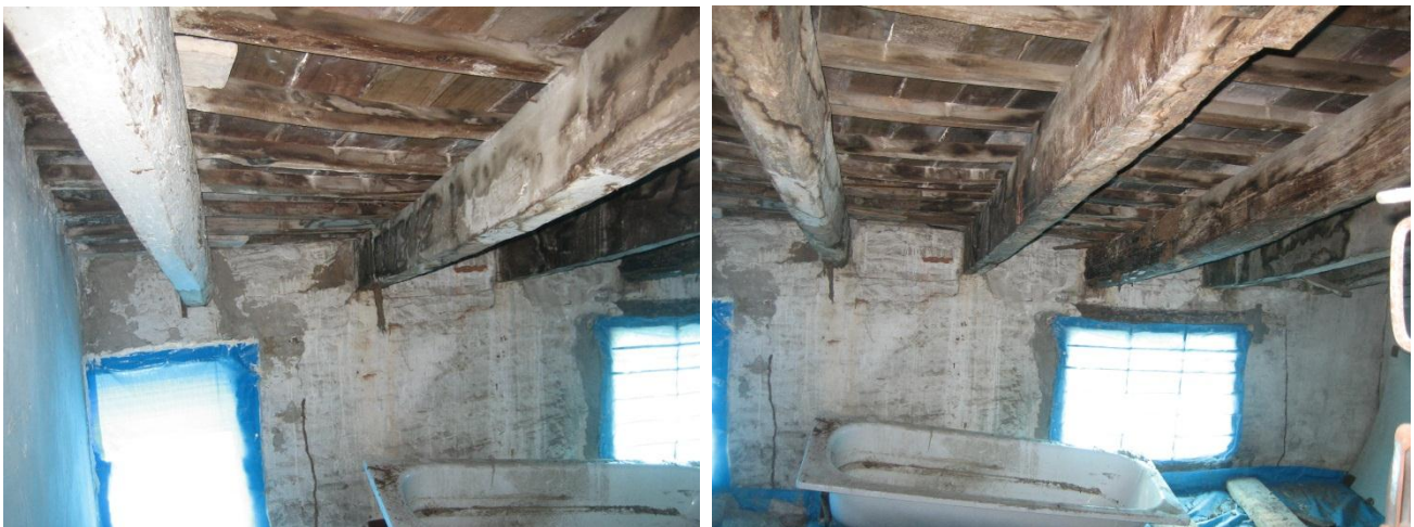
Ilustración 23. Vigas en estado de pudrición forjado cubierta inclinada
