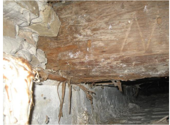
Ilustración 25. Cabeza de vigueta afectada por termitas
