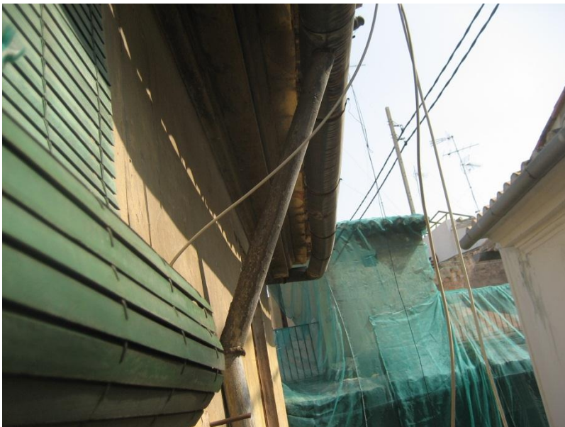
Ilustración 30. Canaleta recogida de aguas
