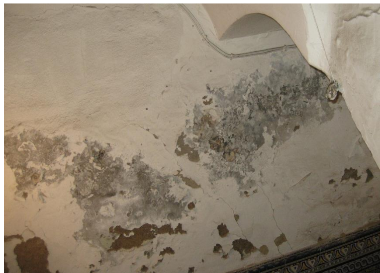
Ilustración 21. Ascensión humedad por capilaridad paramento escalera
