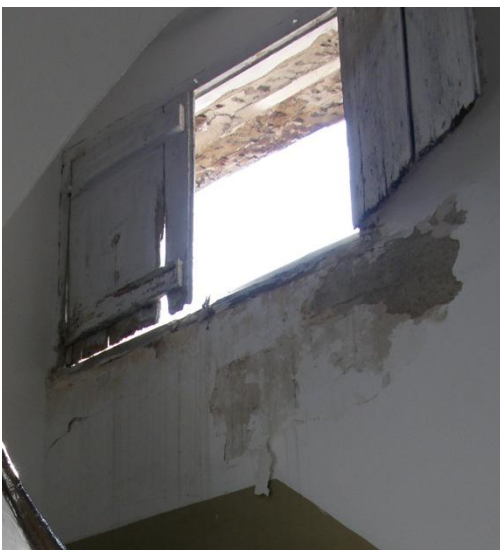
Ilustración 22. Filtración ventana escalera
